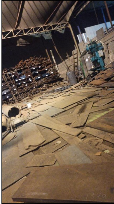
Figura N° 9: Falta de señaléticas y extintores en el área de producción de la empresa EMAVI S.A.C.
