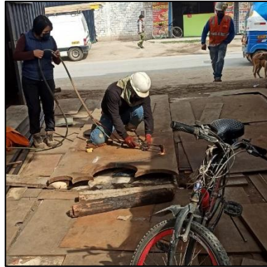
Figura N° 7: Trabajador realizando sus actividades de manera insegura en el suelo
