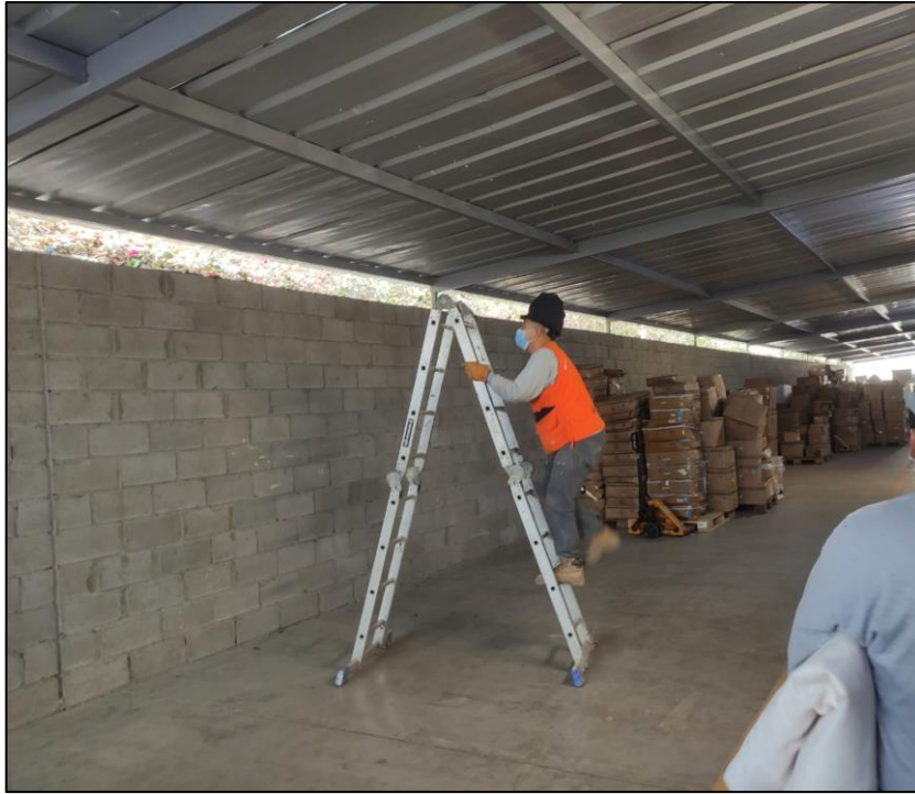
Figura N° 5: Trabajador realizando sus actividades sin su casco de seguridad
