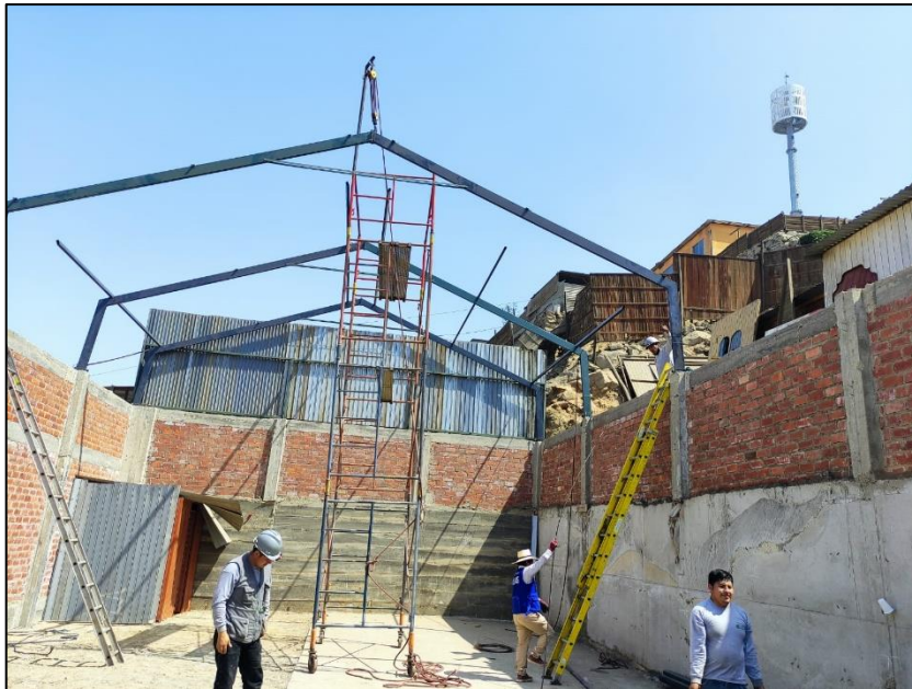
Figura N° 6: Trabajadores realizando sus actividades sin sus Equipos de Protección Personal
