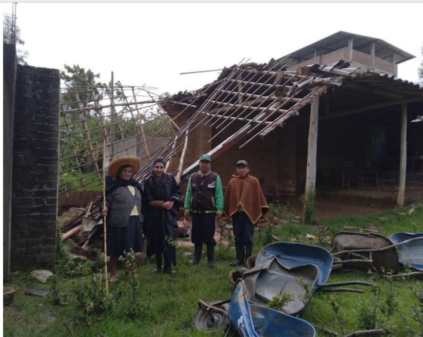
FOTOGRAFÍA 12: Evidencia de daños generados por las fuertes lluvias en el local comunal, diciembre 2021
