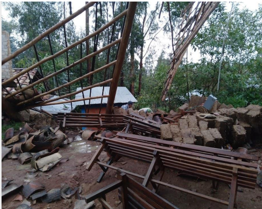
FOTOGRAFÍA 11: Evidencia de daños generados por las fuertes lluvias en el local comunal, diciembre 2021
