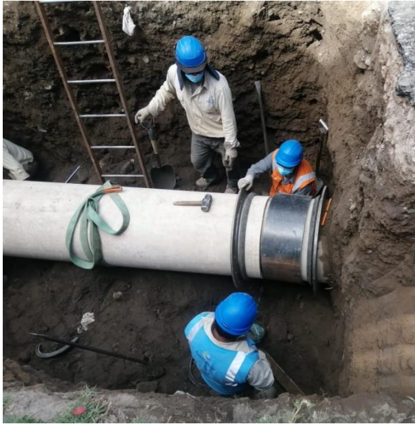
RTC línea de conducción de GRP (fibra de vidrio) de 600 mm Cono Este
