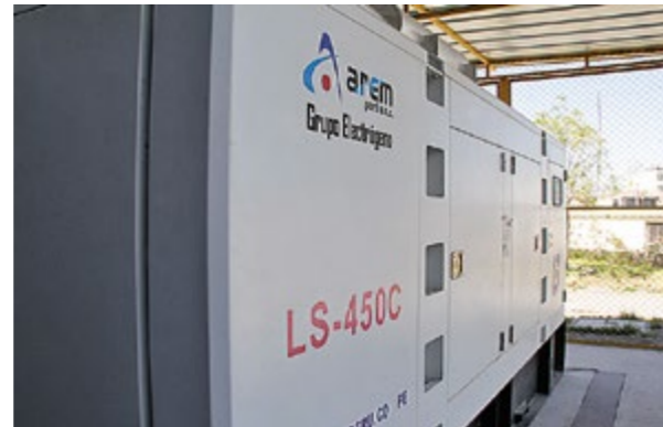
Grupo electrógeno de 450 KV para la PTAP La Tomilla
