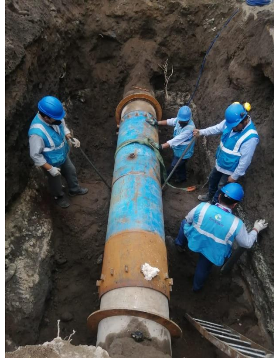
RTC línea de conducción de GRP (fibra de vidrio) de 600 mm Cono Este
