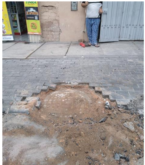
Buzones enterrados por obras de terceros
