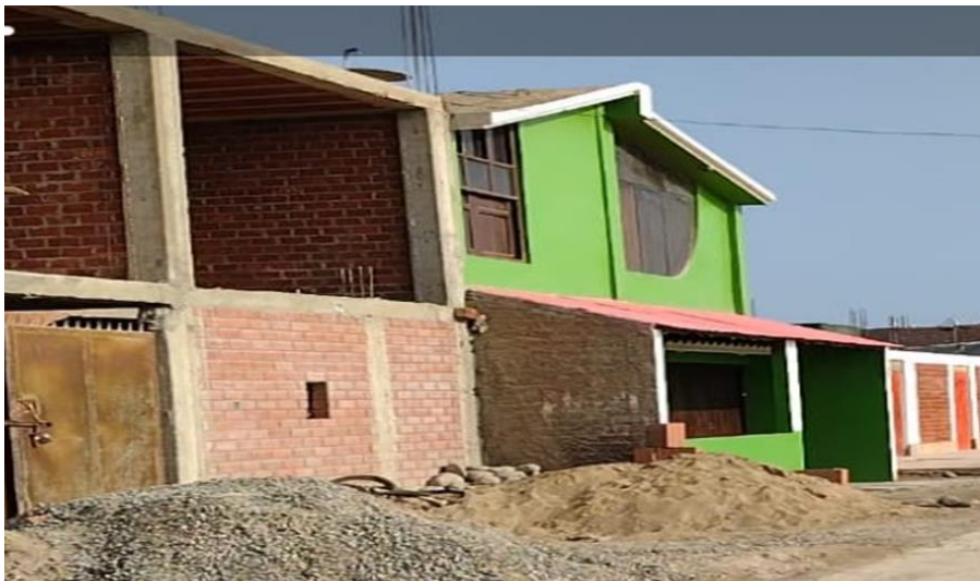
Figura 24 Vivienda de la encuesta N°23, presenta como material predominante la categoría “Albañilería”, misma que muestra un estado de conservación adecuado, Recibe mantenimiento permanente, no presenta deterioro alguno.
