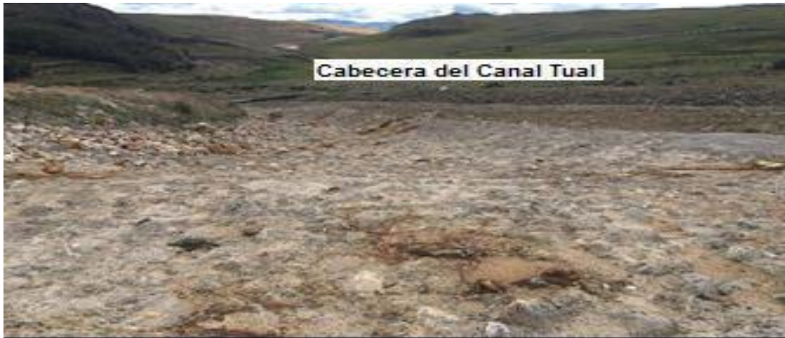
Figura 10. Cabecera del canal de Tual: Falta de agua en la cabecera del canal de Tual
