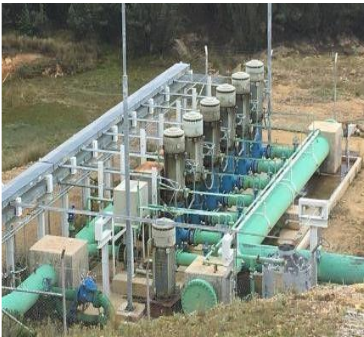
Figura 12. Bombeo de agua tratada al reservorio San José
