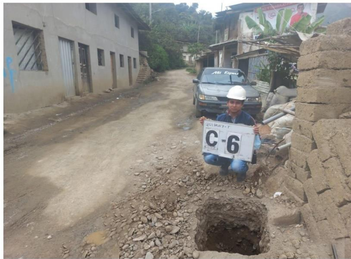
VISTA PANORAMICA DE LA CALICATA C-6 DONDE SE PROYECTO LA RED DE DISTRIBUCION Y RED COLECTORA - CASERIO QUIHUAY
