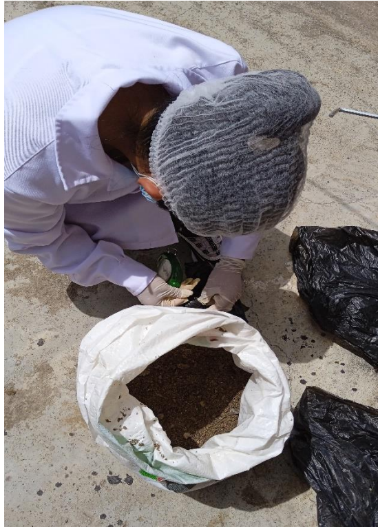
Uso de arena para el acondicionamiento de los filtros.
