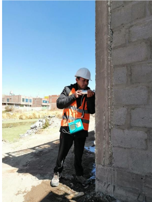
Figura 55. Prueba de esclerómetro en columna vivienda 01 Fuente: Elaboración propia
