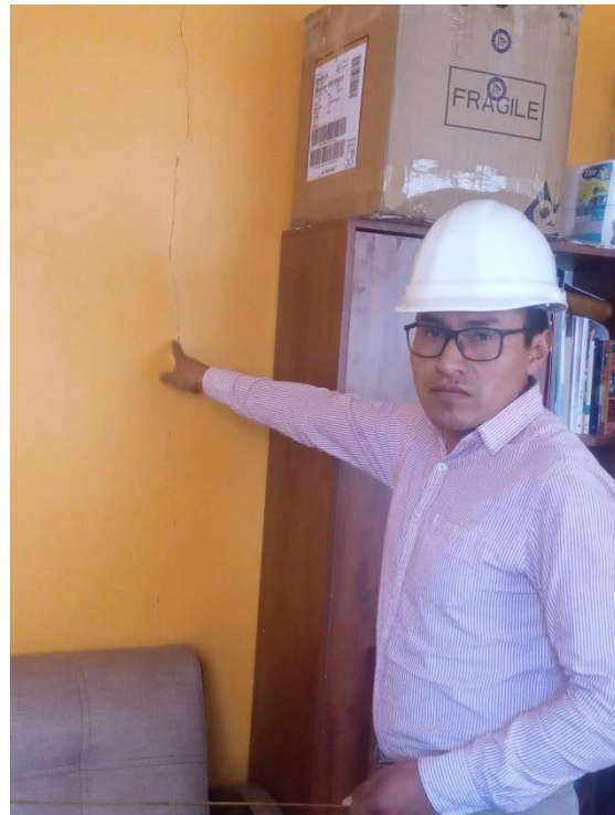
Fisuras a causa del asentamiento en vivienda construida al margen del río Torococha
