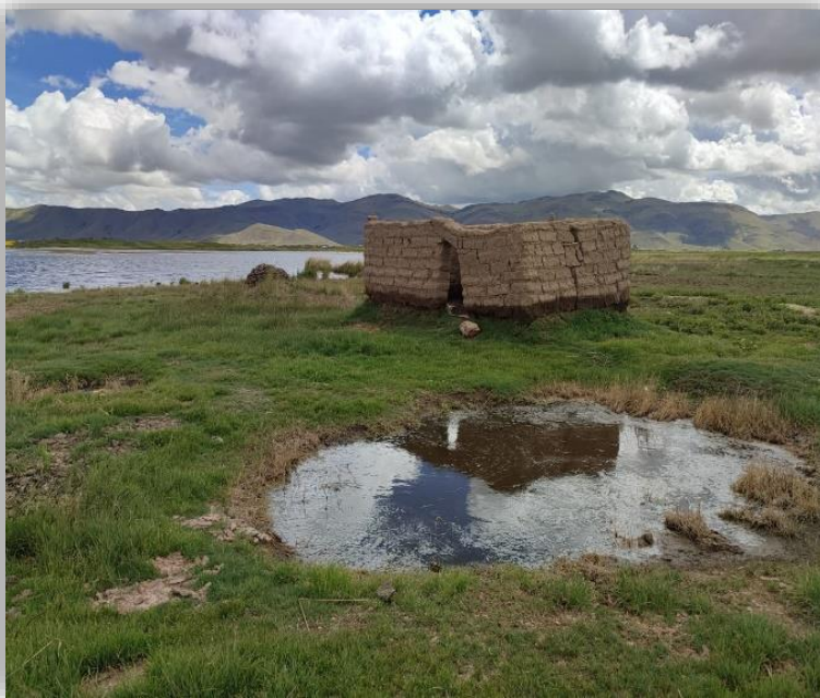
Figura 59. Vivienda desalojada a causa de inundaciones y ya no se puede vivir en dicha vivienda.
