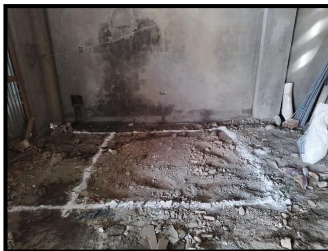
Figura 17: Zona de excavación para cisterna de almacenamiento de agua Fuente: Elaboración propia
