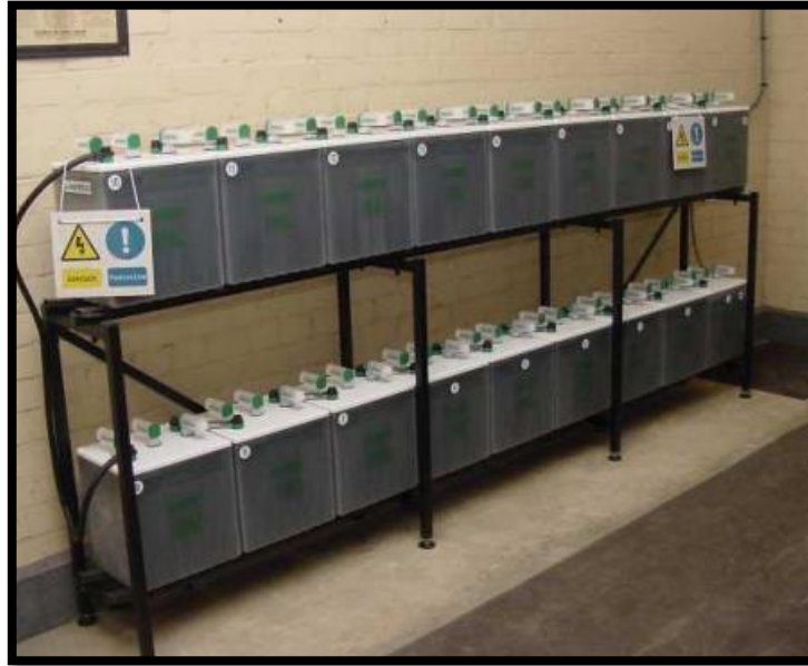
Figura 8: Conjunto de baterías Fuente: Revista Medio Ambiente - Energías renovables
