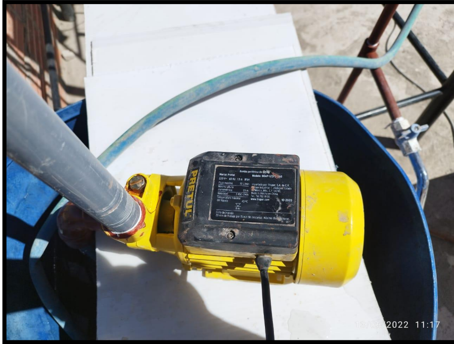
Figura 5: Bomba o motor de succión (1/2Hp) Fuente: Elaboración propia
