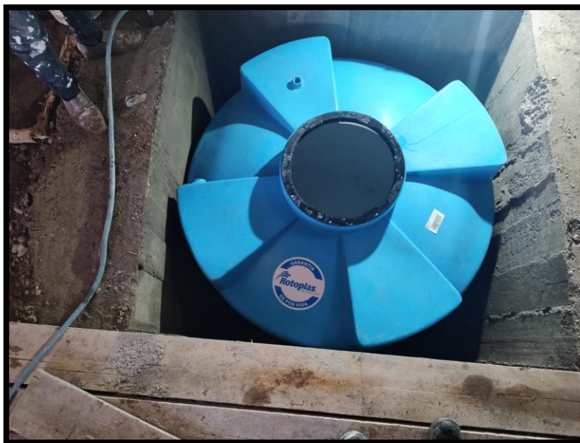
Figura 3: Almacenamiento de a gua en cisterna Fuente: Elaboración propia
