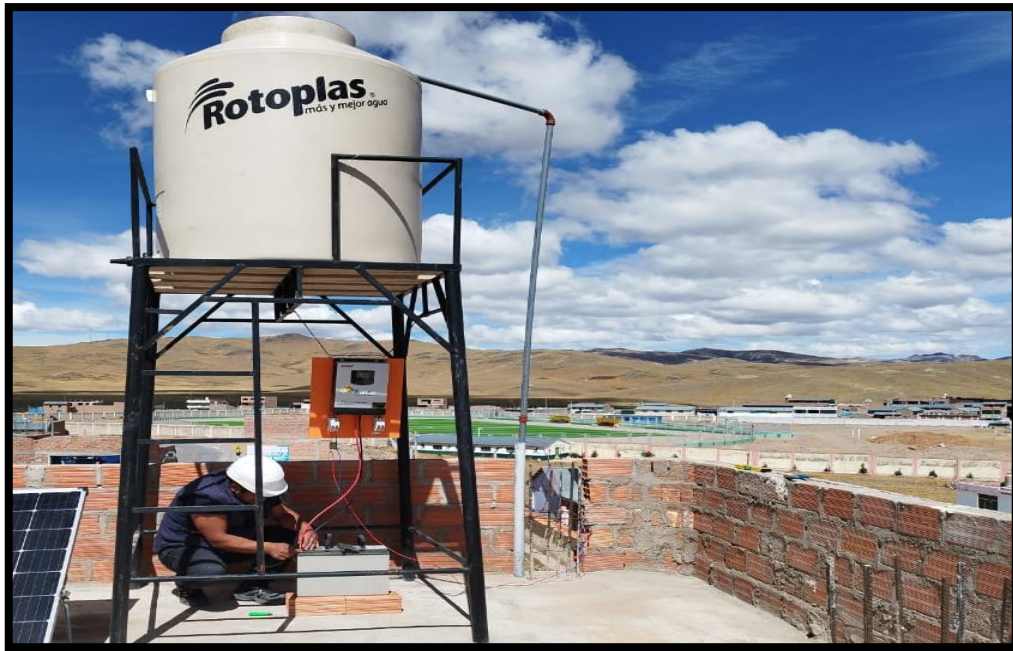
Figura 26: Tanque elevado Fuente: Elaboración propia
