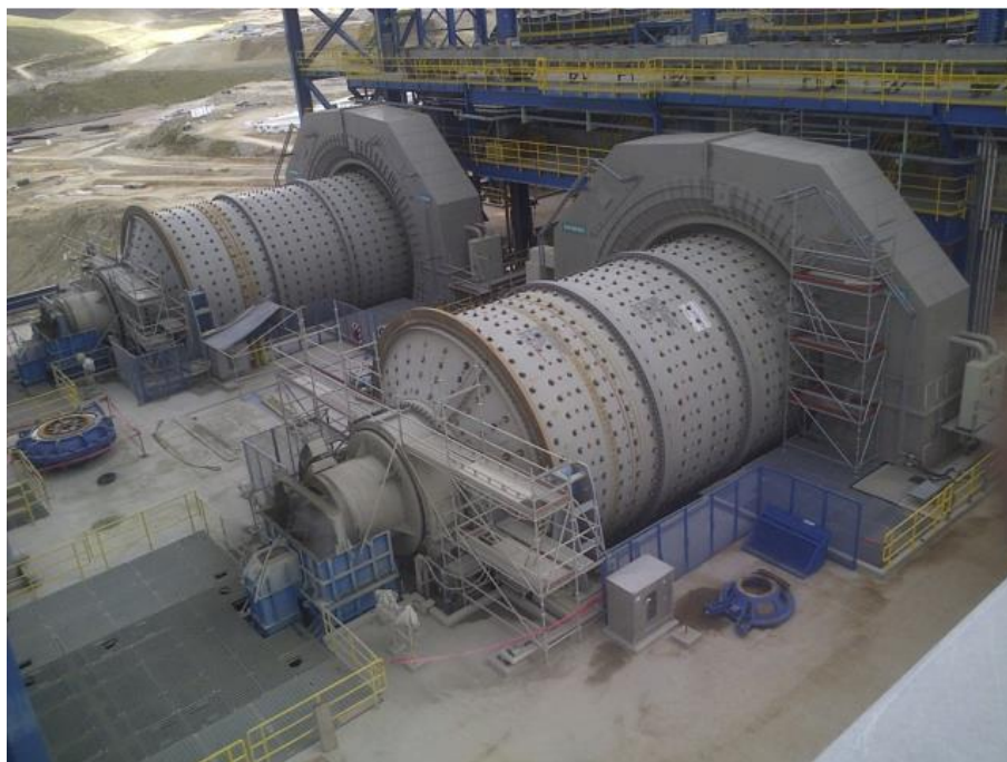
Figura 14. Ball mill en operación de 7.9 m de diámetro en la mina Tintaya Antapaccay (Wills y Finch 2015).
