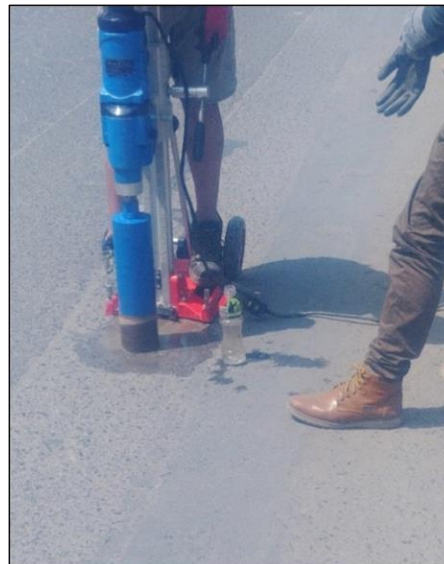
Imagen 08: Penetración de carpeta asfáltica falla 02 Prog. Km. 1+900
