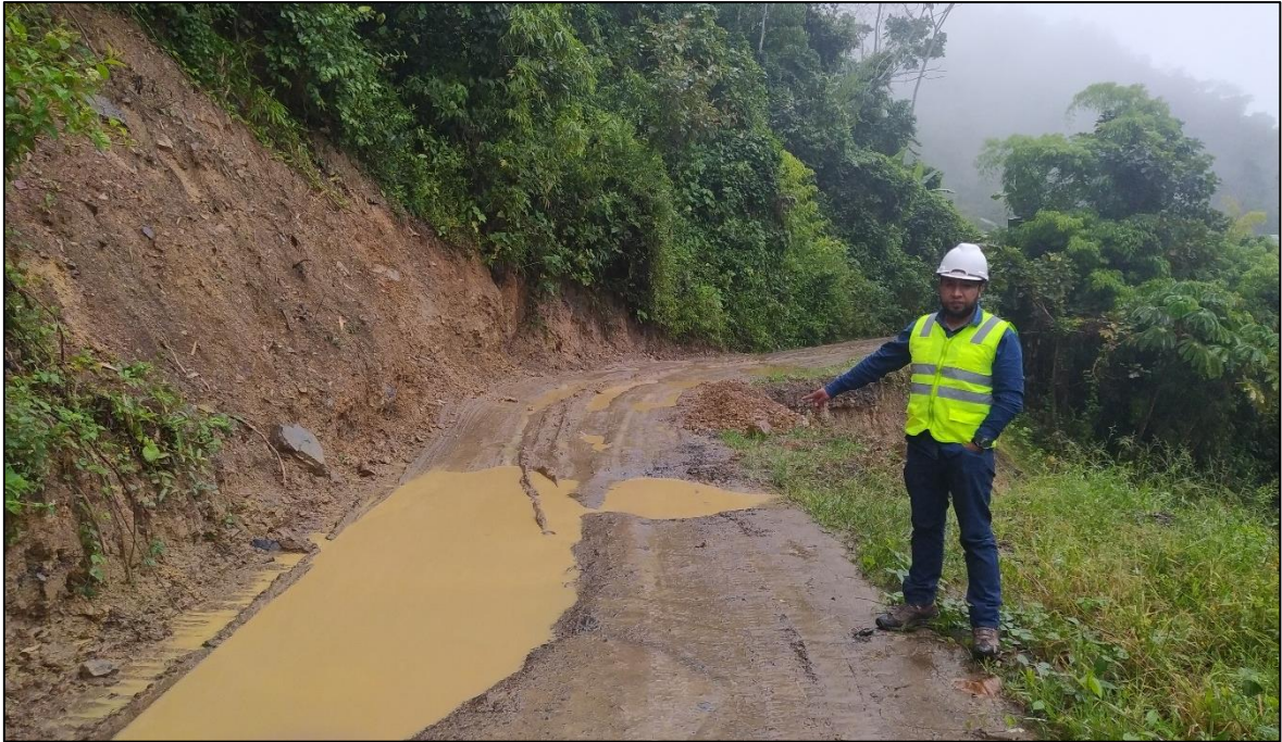
Fotografía 06. Se tiene la sobresaturación de la vía causado por la baja resistencia del material con la que está conformado el camino vecinal.
