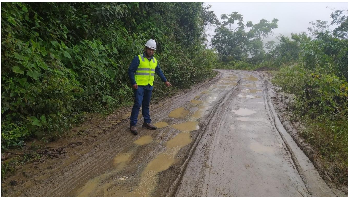
Fotografía 05. Se observa el ahuellamiento producido por los vehículos que hacen uso de la vía, esto sucede por la poca resistencia que presentan los suelos con los que se le hace mantenimiento a estos caminos.
