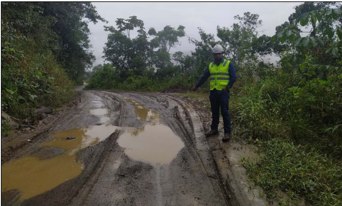
Imagen 2. Evidencias del mal estado de la vía a causa de las precipitaciones pluviales, estado situacional (2022).
