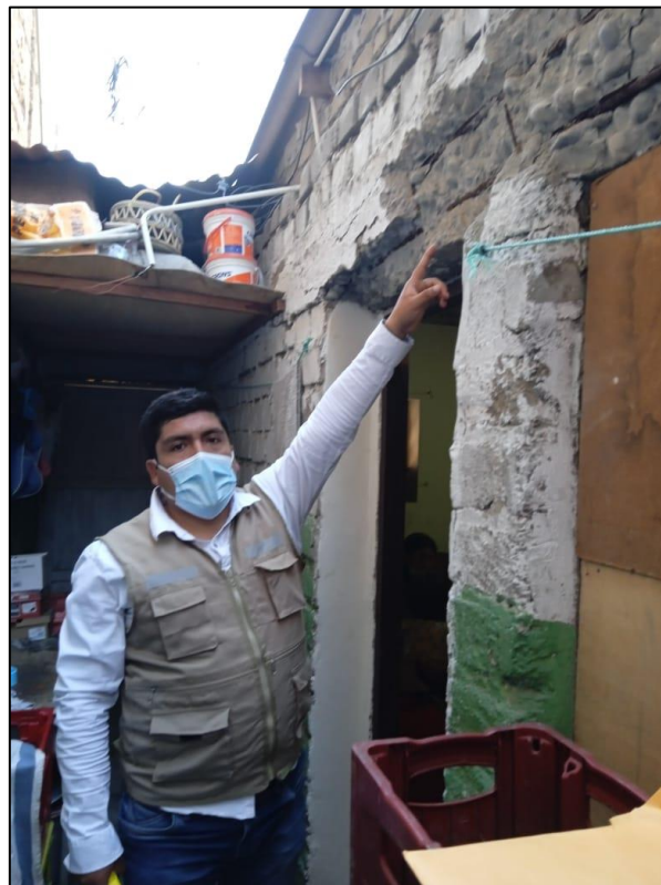
Figura 44. Se observa el interior la exposición del acero. Tomado de Elaboración Propia.
