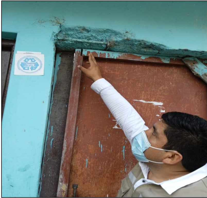
Figura 41. Se observa el exterior la exposición del acero. Tomado de Elaboración Propia.
