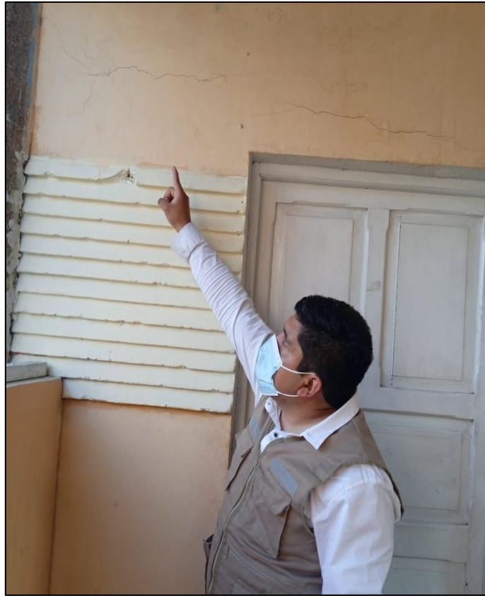
Figura 43. Se muestra las fisuras en fechada. Tomado de Elaboración Propia.
