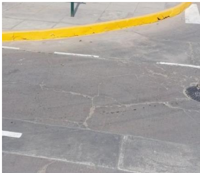
Figura 3. Agrietamiento exponencial en gran parte del pavimento rígido en la intersección de la Av. Circunvalación con Av. Cerro Chico.
