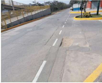
Figura 1. Pequeños forados y grietas a lo largo del pavimento rígido de la Av. Circunvalación, se evidencia deterioro progresivo por agentes externos
