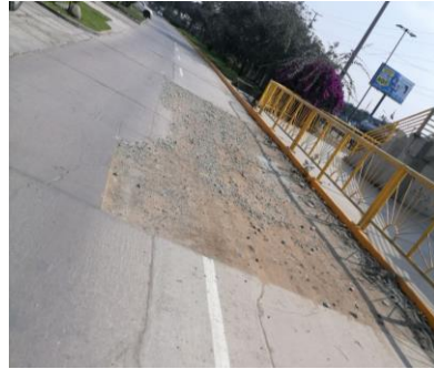
Figura 2. El pavimento rígido presenta deterioro progresivo en plano longitudinal debido a impurezas ajenas que maltratan el pavimento, se visualiza que el reemplazo de la sección quedó inconclusa.
