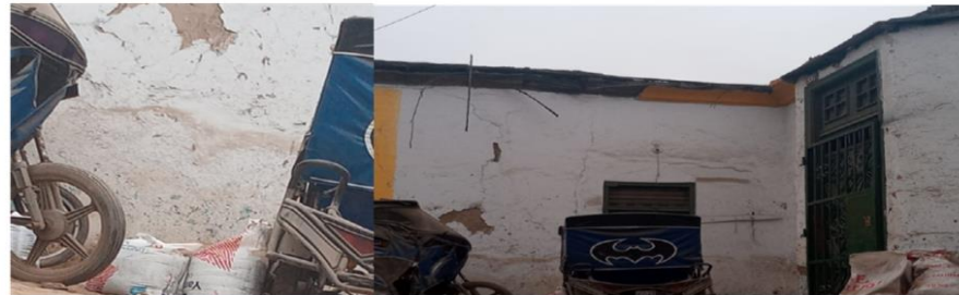
Suciedad en la fachada
