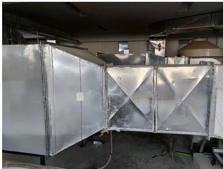
Figura 21. Unidades manejadoras de aire limpiadas – Piso Técnico
