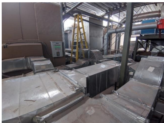
Figura 19. Polvo encima de los ductos
