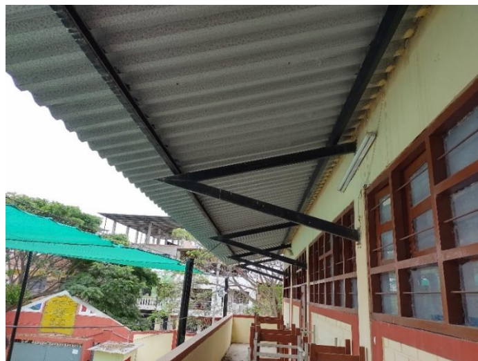
Figura 8. Techo de calamina en el pabellón
