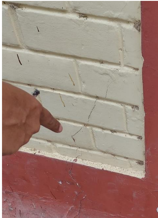
Figura 7. Grieta en muro de confinamiento.
