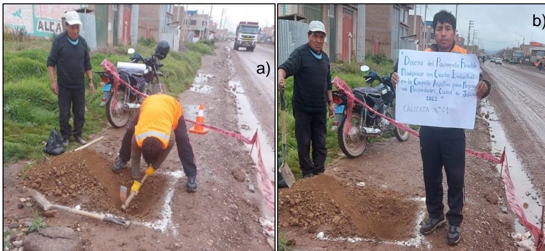
Figura 15. Excavación calicata C-1 a) Inicio de excavación b) Proceso de excavación Fuente: Propia del investigador
