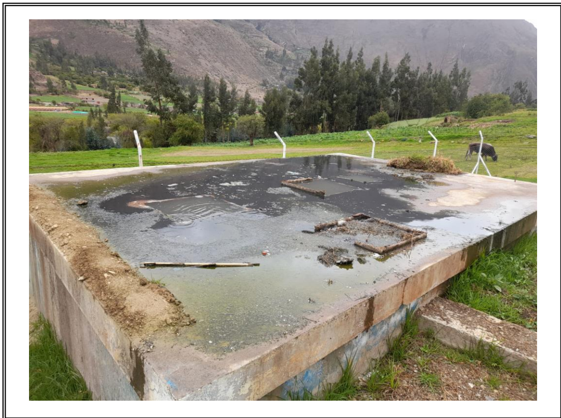
Foto 22: Tanque séptico desbordado
