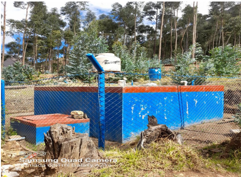
Foto 14: Reservorio N° 1 de 15 m 3
