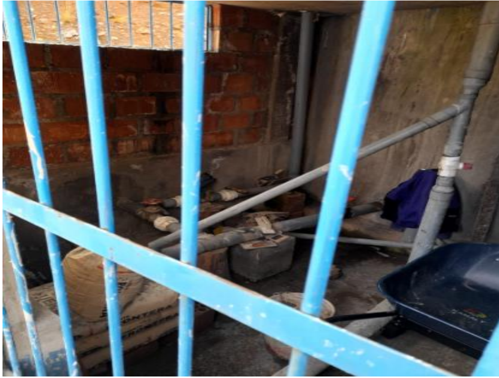
Foto 17: Caceta de válvulas reservorio N° 2
