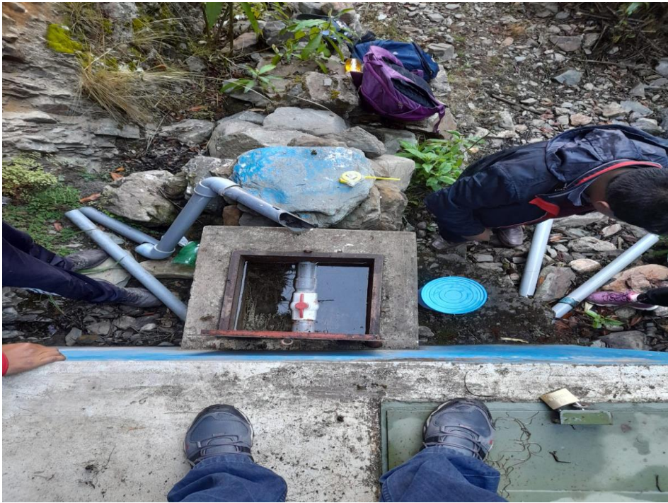
Foto 9: Cámara de válvulas
