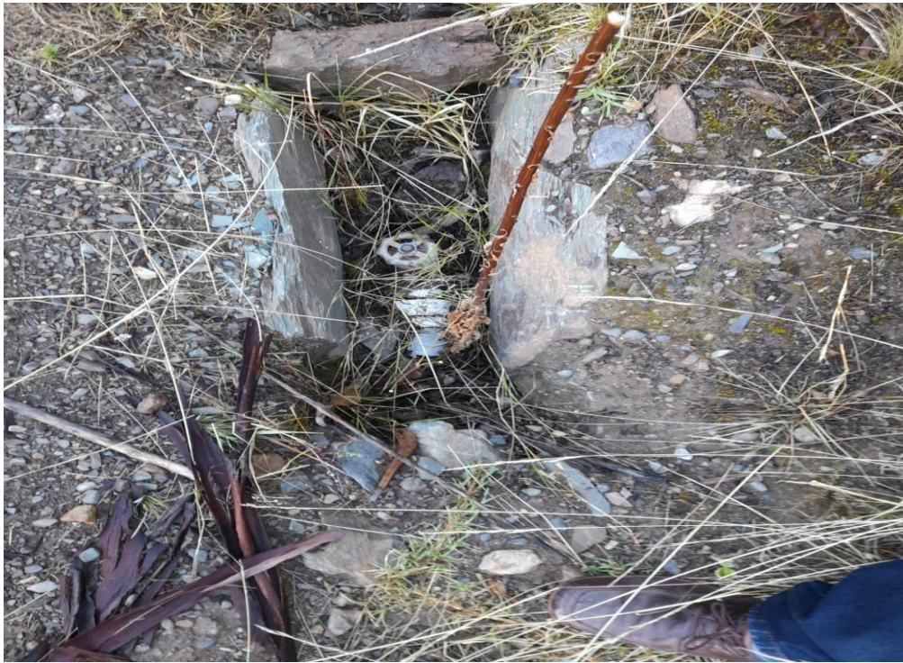
Foto 18: Válvula de purga sin mantenimiento
