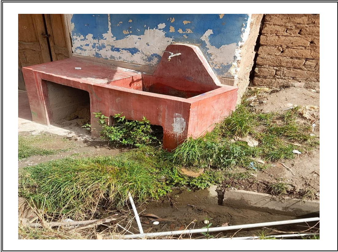
Foto 19: Modulo de lavatorios sin mantenimiento
