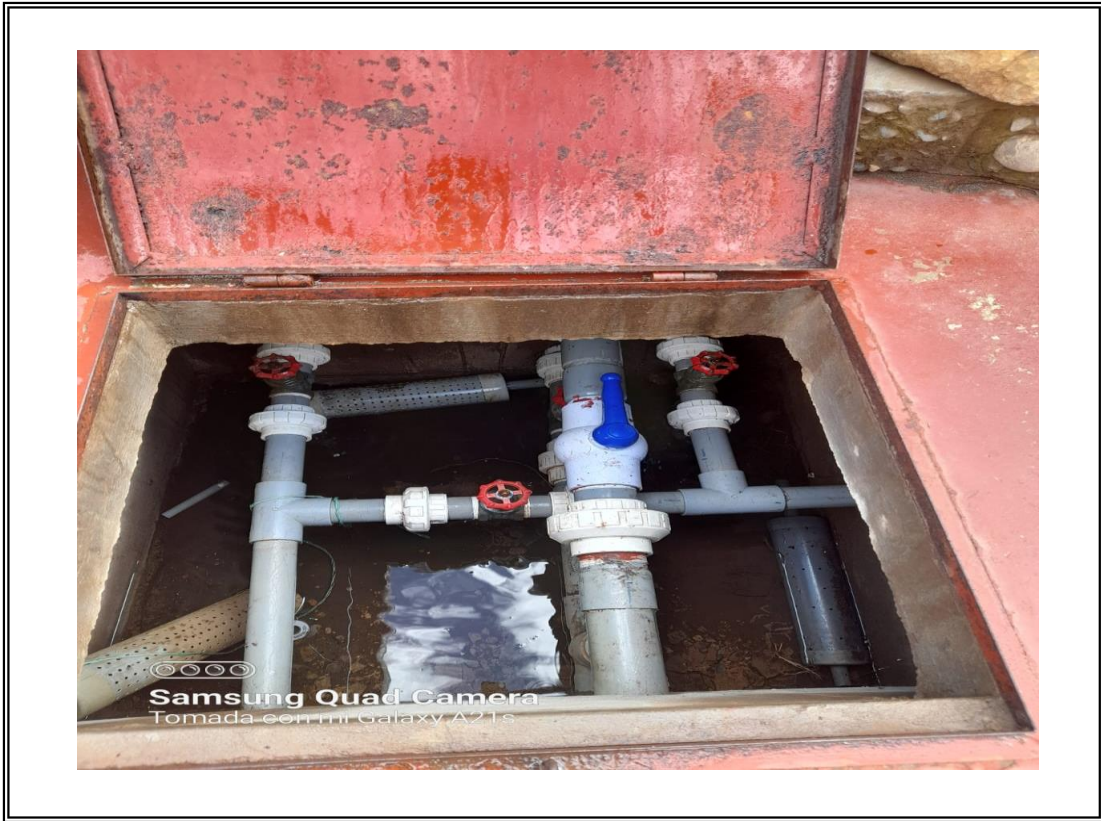
Foto 15: Cámara de válvulas del reservorio N° 1
