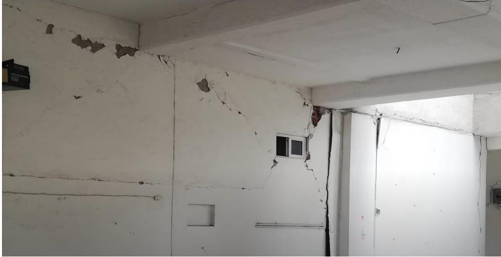
Figura 9. Edificios con rigidez laterales insuficientes antes los antecedentes sísmicos
