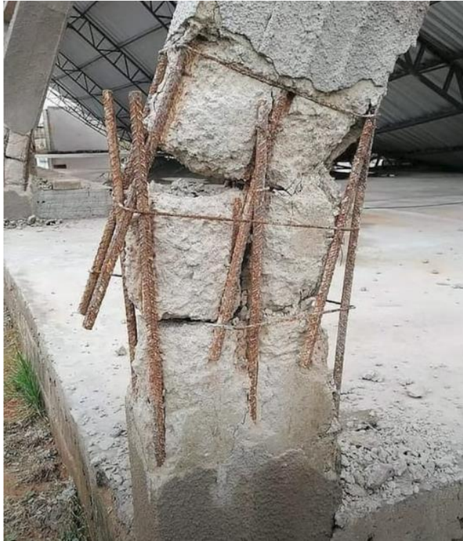
Figura 11. Edificios con vigas / columnas con traslapes insuficientes
