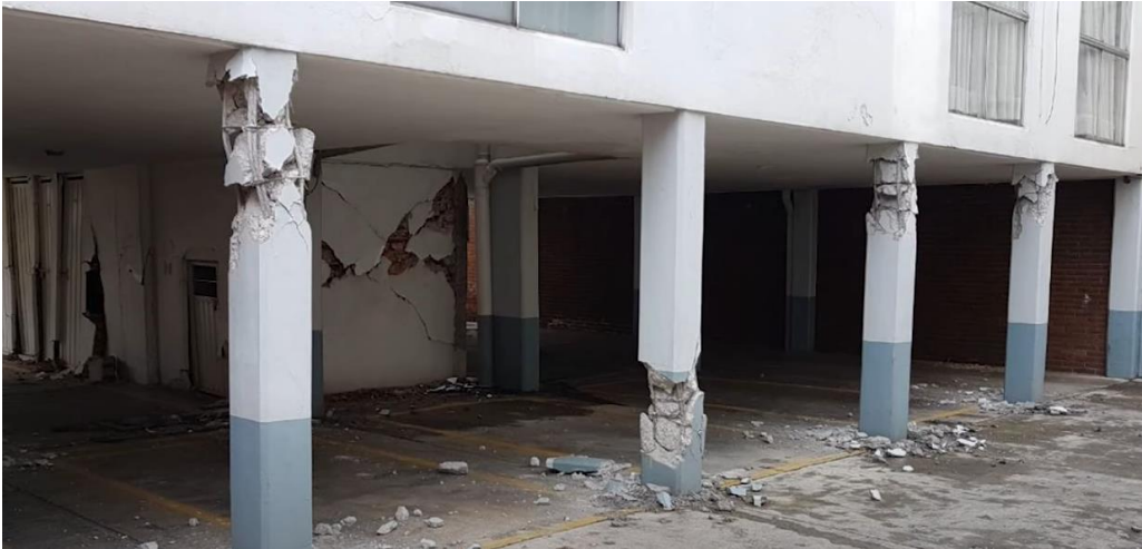
Figura 10. Edificios con niveles inferiores débiles
