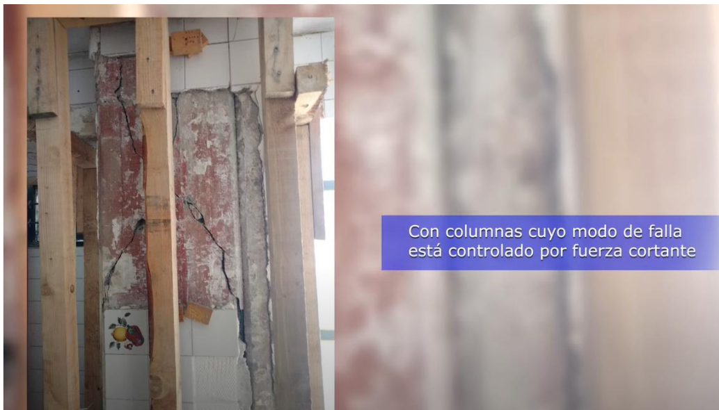
Figura 8. Edificios de columnas cuyas fallas son por fuerzas cortantes (afectan el desempeño físico de toda la edificación)
