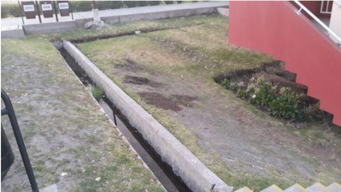
Foto 7; Existencia de canal de agua frente al pabellón
