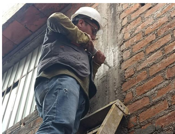
Figura 52. Ensayo de esclerometría
