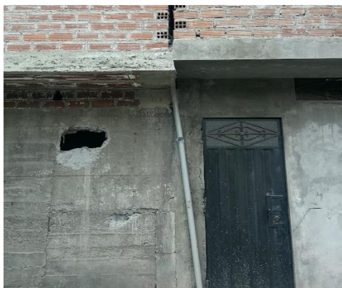
Figura 15 Vivienda sin juntas sísmicas
