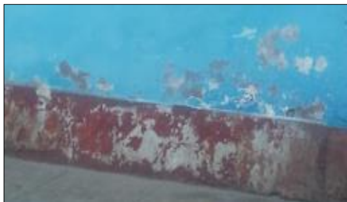
Figura 13 Muro portante y/o no portante con humedad
