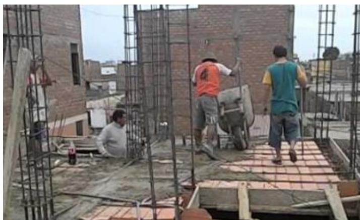
Figura 14 Construcción de viviendas sin supervisión técnica
