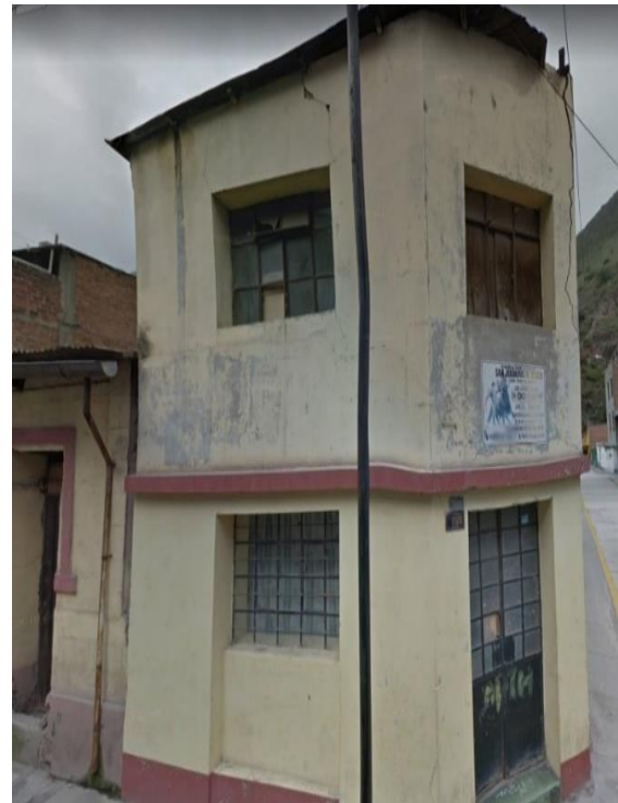
Figura 2 Falla rajadura en paredes
