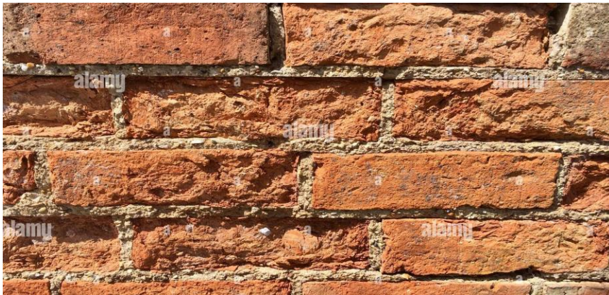
Figura 4: Ladrillos erosionados por agua
