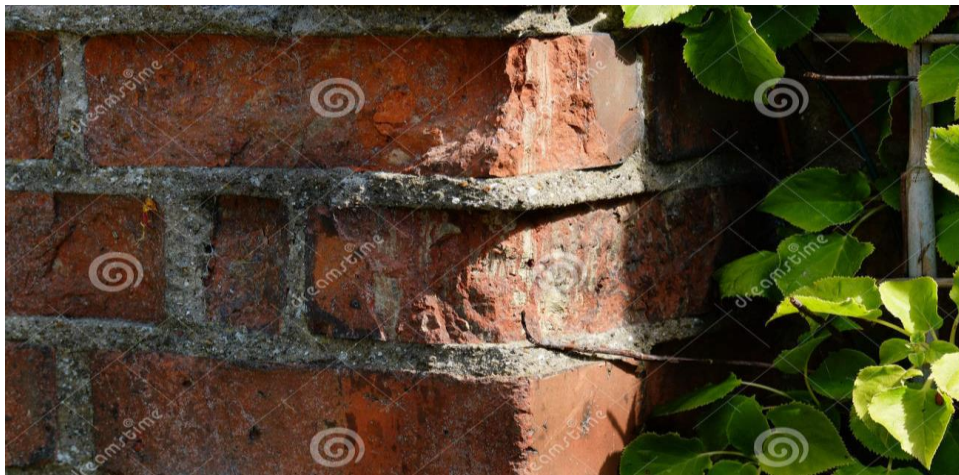
Figura 2: Pared de ladrillos severamente desgastados
