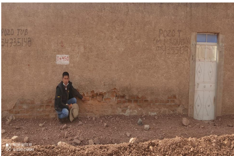
Presencia de eflorescencia y erosión en el muro.
