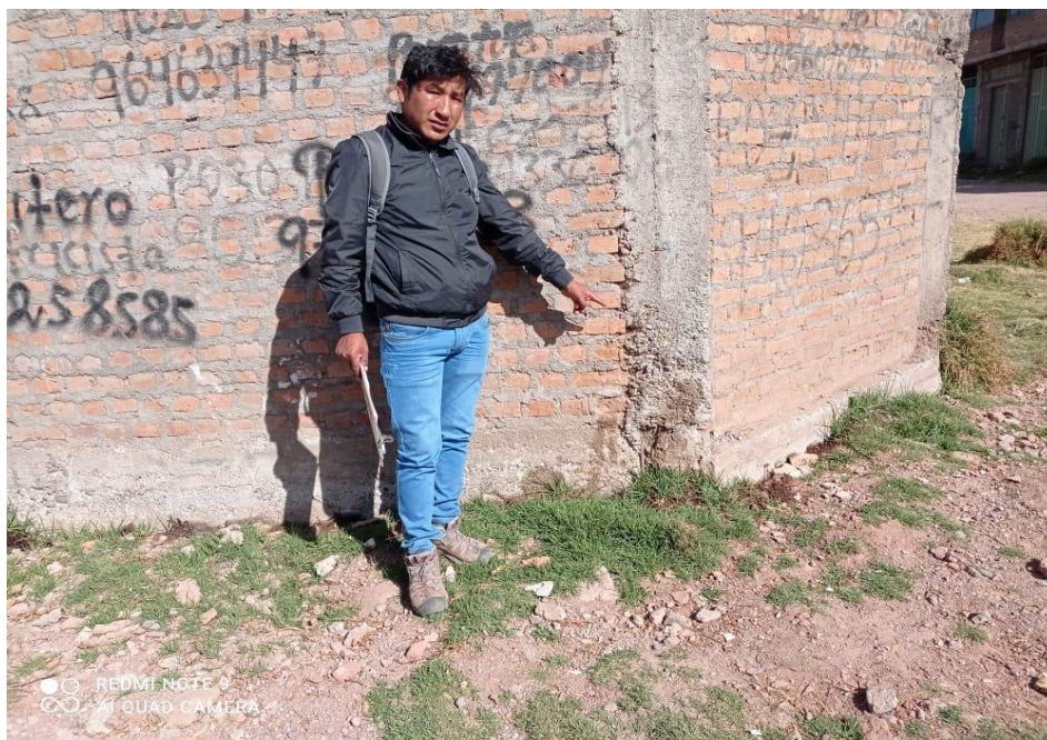
Desprendimiento en la parte inferior de la columna.
