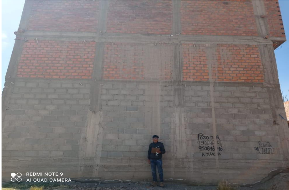
Presencia de erosión y humedad en la parte inferior del muro.
