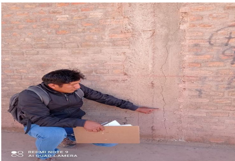
Fisura longitudinal en la columna.
