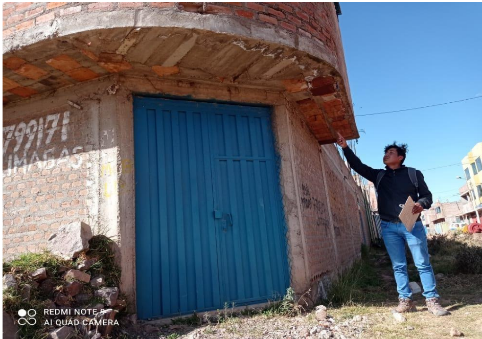
Corrosión en el acero en la losa de la vivienda y eflorescencia.
