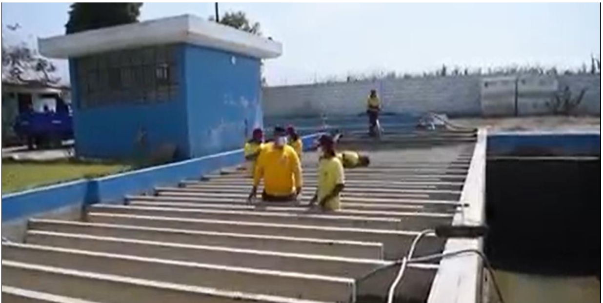
Anexo F2. Pozas de sedimentación de la planta de tratamiento de agua de la municipalidad de Ascope
