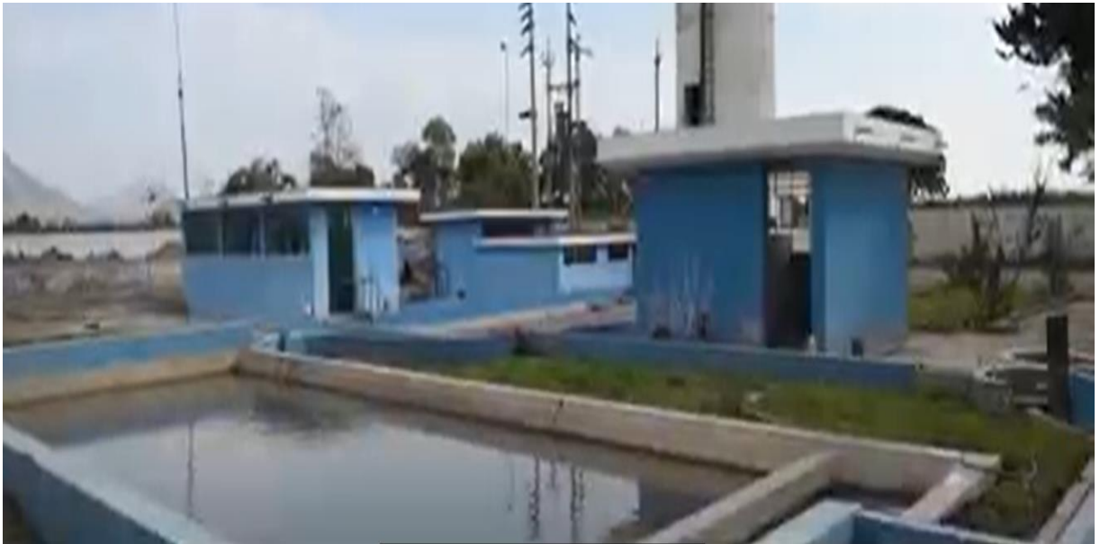
Anexo F1. Planta de tratamiento de agua municipal de Ascope
