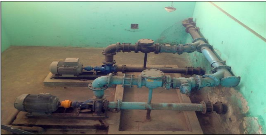
Anexo F3. Bombas de agua
