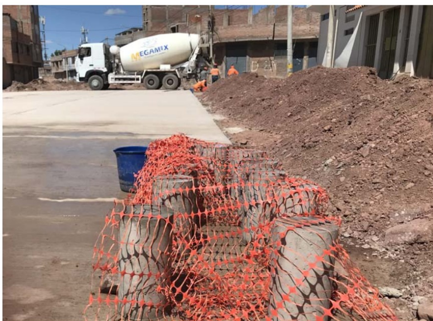
Fotografía 24. Proceso de curado – Muestra no sumergida in situ (A)
