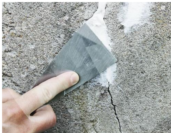
Figura 6. Fisura superficial en el concreto Fuente: https://binged.it/3jiFDxg (2019)
