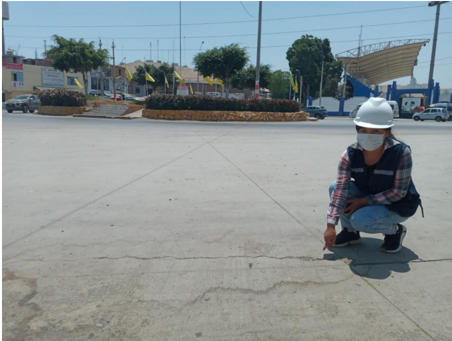
Figura 01. Av. Mariscal Benavides, tramo donde se observa las fisuras
