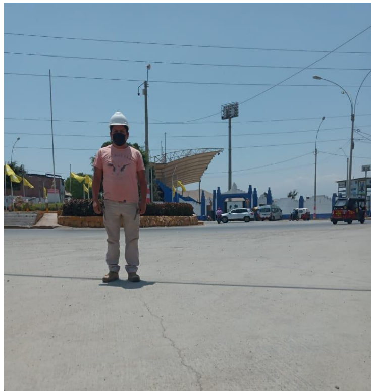
Figura 02. Av. Mariscal Benavides, tramo donde se observa las fisuras
