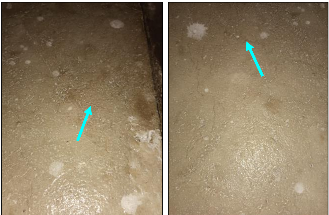
Figura 24. Fisuras observadas en el concreto experimental
