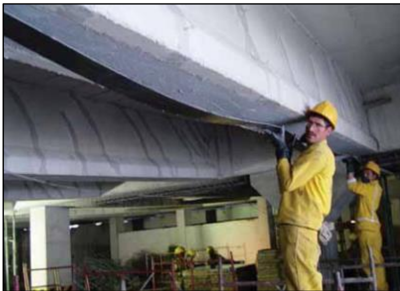
Figura 7. Fisura superficial en vigas
