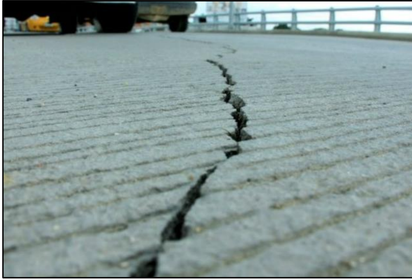
Figura 8. Fisura superficial en pavimentos
