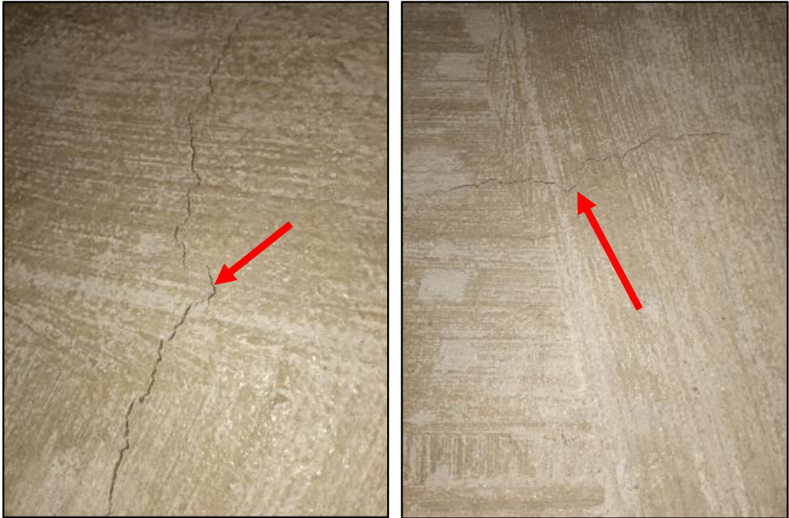
Figura 23. Fisuras observadas en el concreto normal (patrón)
