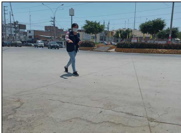
Figura 9. Fisura generados por esfuerzos en el pavimento.
