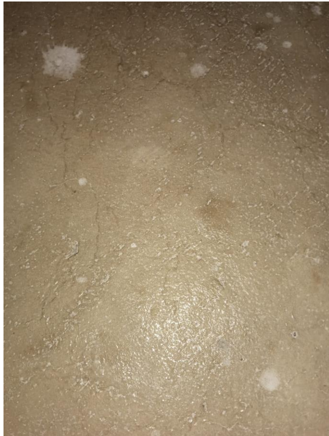
Figura 16. Se visualiza las fisuras que se ha generado después del fraguado, molde sin curador
