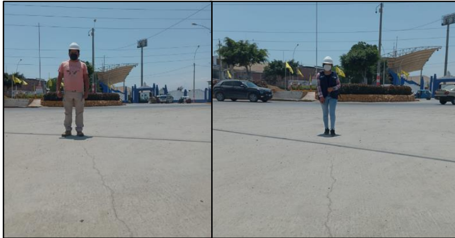
Figura 2. Fisuras estructurales en losas de concreto
