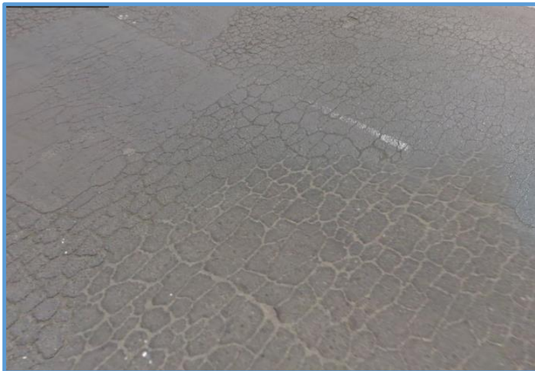
Figura 07: Estado del Agrietamiento en bloque
