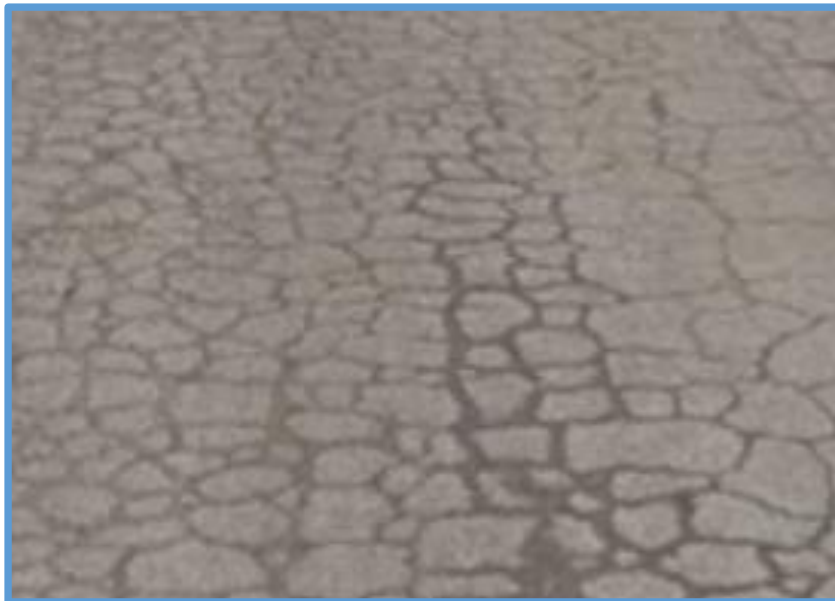
Figura 05: Estado de grietas en bloque
