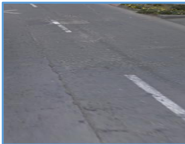
Figura 09: Grieta de Reflexión de junta
