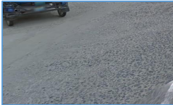
Figura 21: Desprendimientos de agregados
