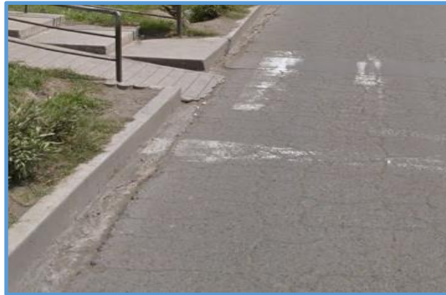
Figura 08: Grieta de Borde
