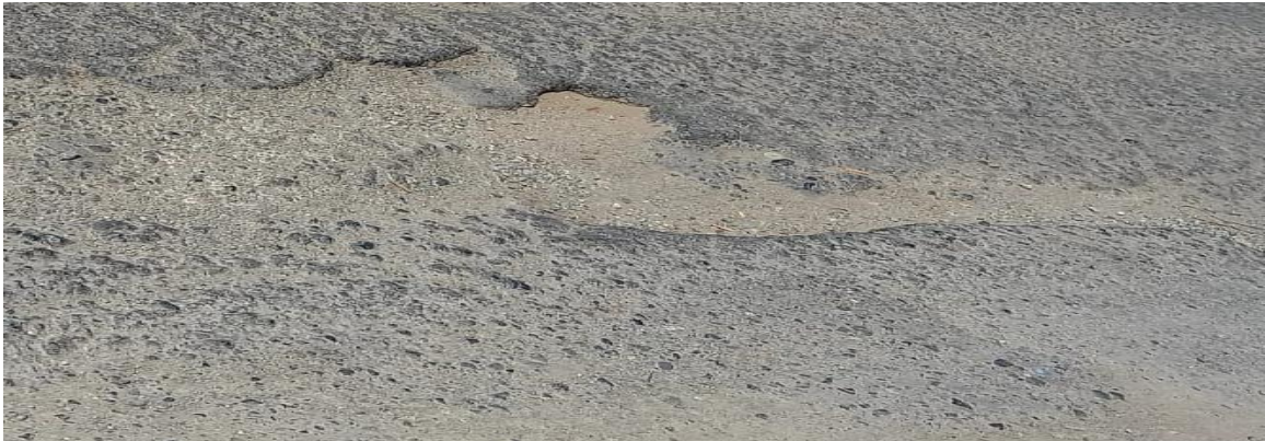
Huecos en la calzada izquierda
