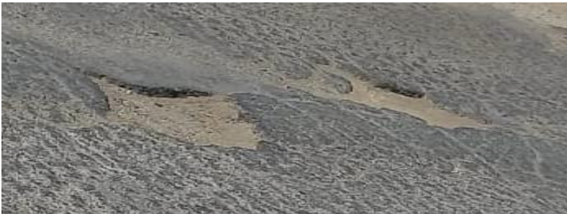
Huecos en la calzada derecha
