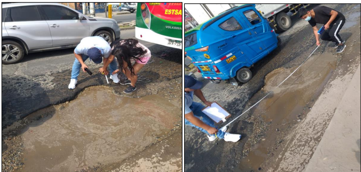
Huecos en la calzada izquierda con mayor nivel de severidad
