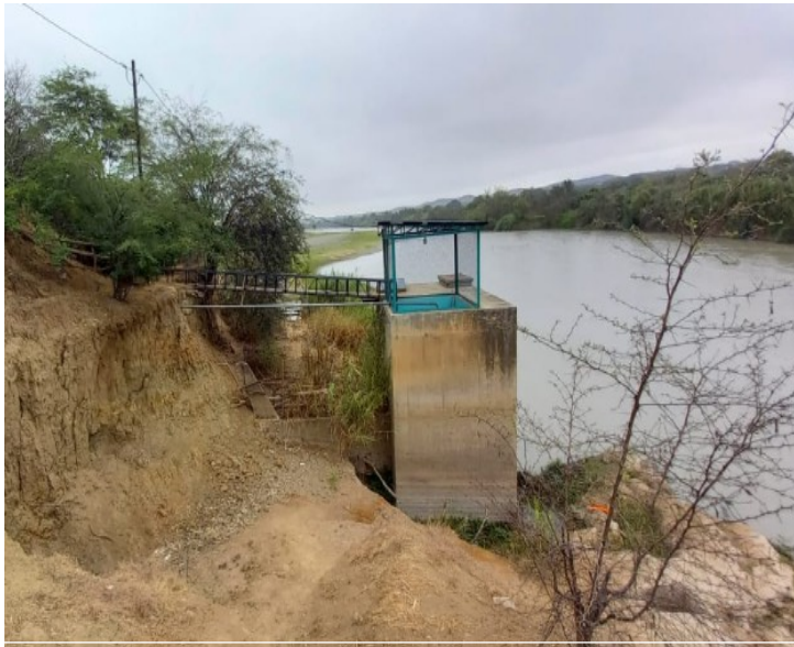
DESCRIPCIÓN: CAPTACIÓN DEL CENTRO POBLADO VAQUERIA FUENTE: ELABORACIÓN PROPIA.
