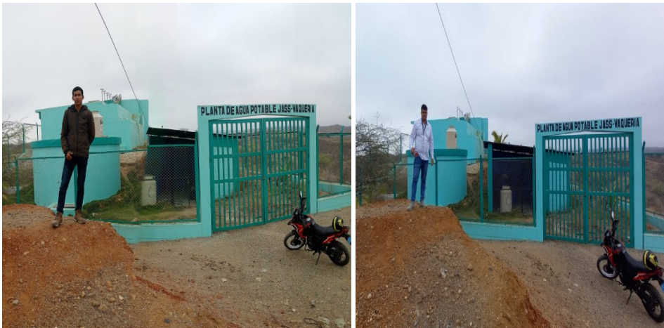
DESCRIPCIÓN: PLANTA DE AGUA POTABLE JASS- VAQUERÍA. FUENTE: ELABORACIÓN PROPIA.
