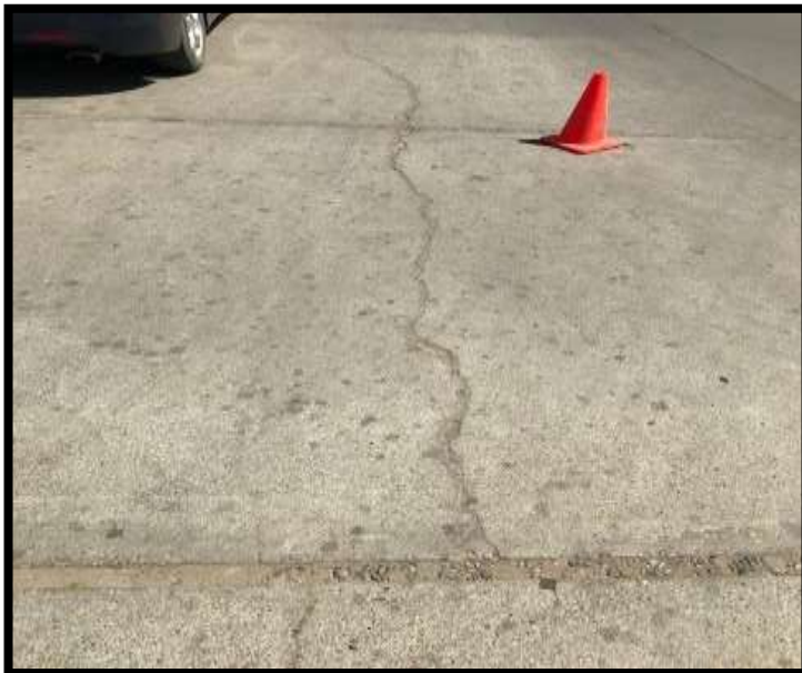
Anexo 10: Tipo de falla de grieta transversal
