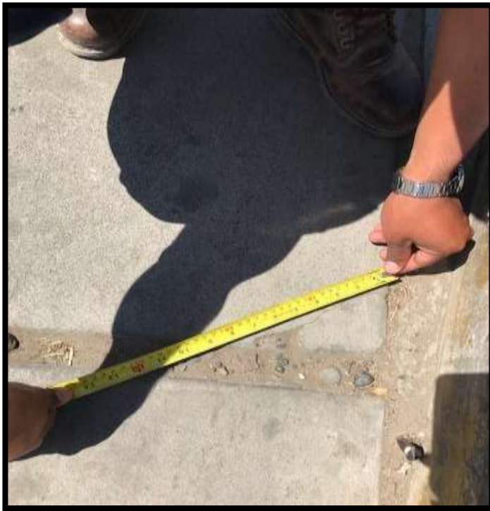
Anexo 1. Medición de las fallas en el pavimento
