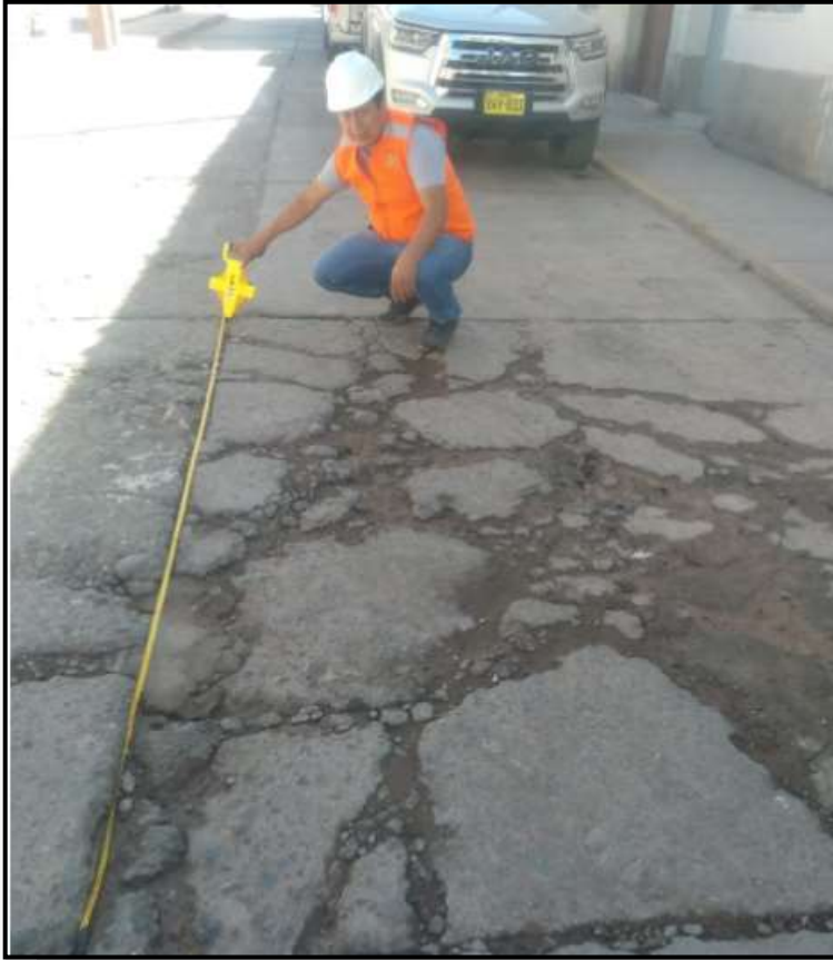
Anexo13: Medicion de la falla Agrietamiento en bloque
