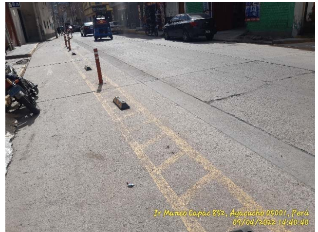
Figura 12. Vista de separadores físicos dañados. Fuente: elaboración propia.
