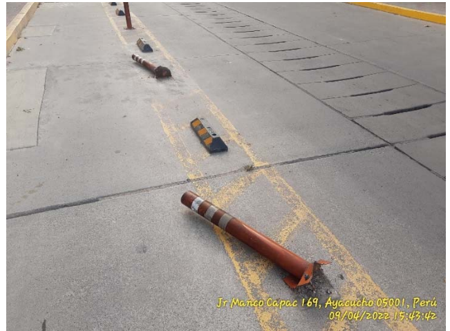
Figura 20. Vista de bolardos dañados. Fuente: elaboración propia.
