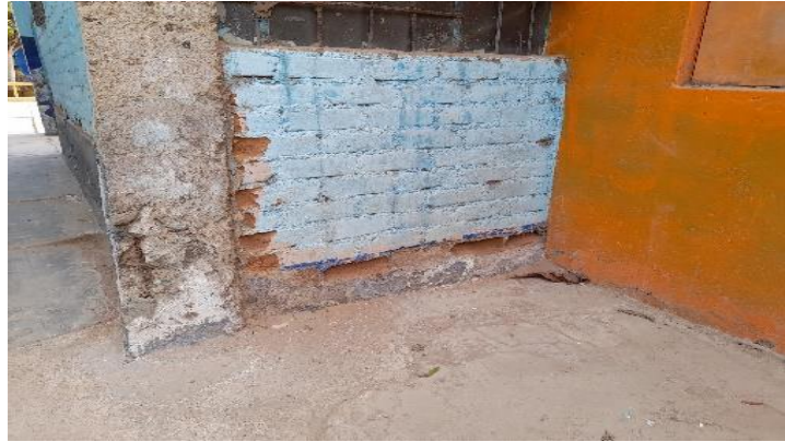
Figura 12. Muro y columna en mal estado – Pabellón 04
