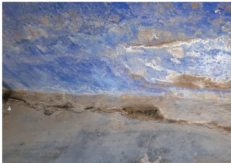
Figura 25. Muro con problemas de salitre - Biblioteca
