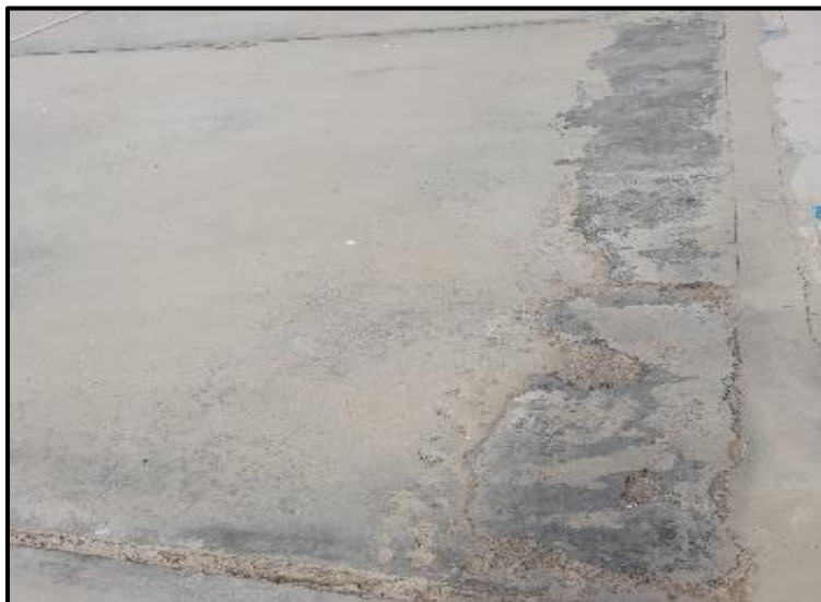
Figura 52. Paño en mal estado en Patio de formación
