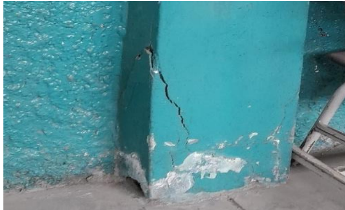
Figura 3. Grieta en elemento estructural – Pabellón 01
