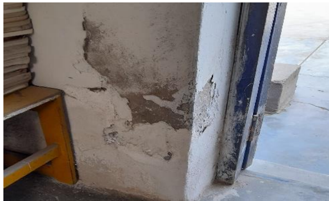
Figura 27. Muro interno con problemas de salitre - Biblioteca
