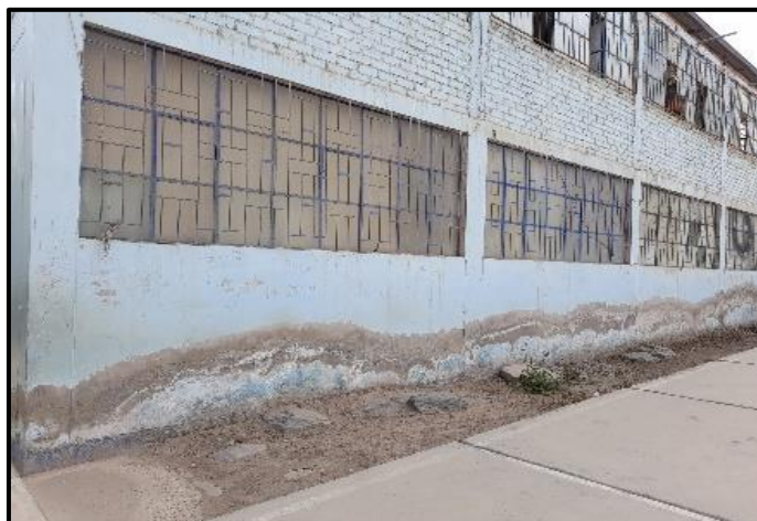
Figura 40. Mal estado de Pabellón 03
