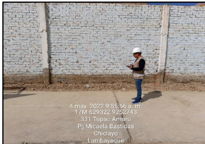
Figura 53. Muros y columnas de cerco en mal estado
