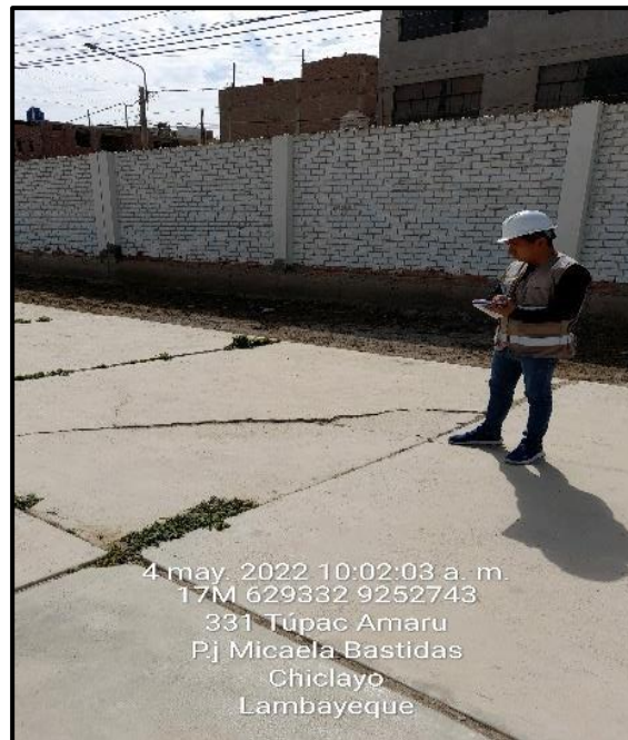
Figura 51. Fractura de paño en losa deportiva
