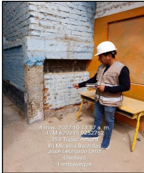
Figura 41. Mal estado de Pabellón 04
