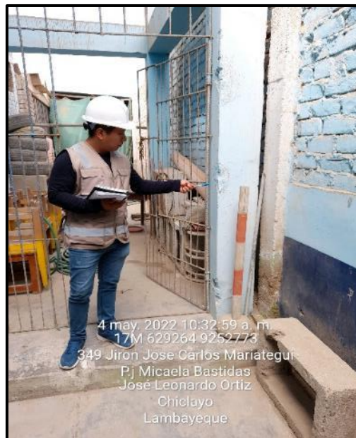
Figura 46. Columnas en mal estado de Tanque elevado.
