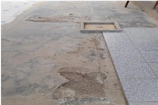
Figura 34. Paños en mal estado - Patio
