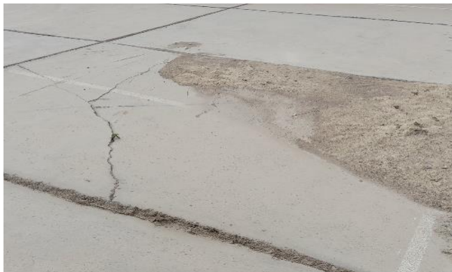
Figura 35. Paños en mal estado – Losa deportiva
