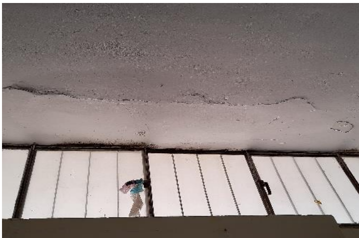
Figura 5. Agrietamiento en losa aligerada – Pabellón 01
