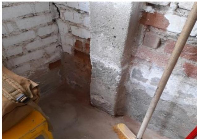
Figura 30. Columna en mal estado - Almacén
