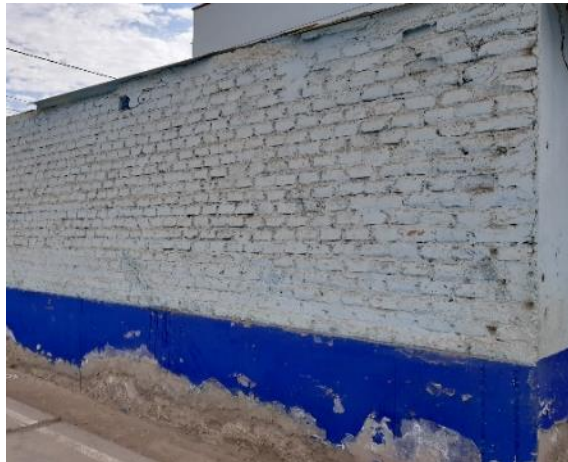
Figura 33. Muro en mal estado - Logística
