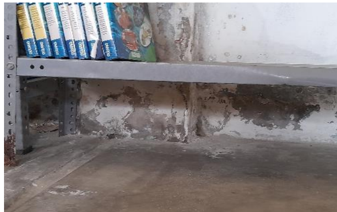
Figura 28. Muro interno con problemas de salitre - Aula
