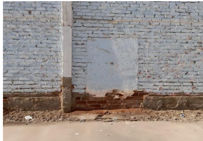
Figura 37. Columnas en mal estado – Cerco perimétrico
