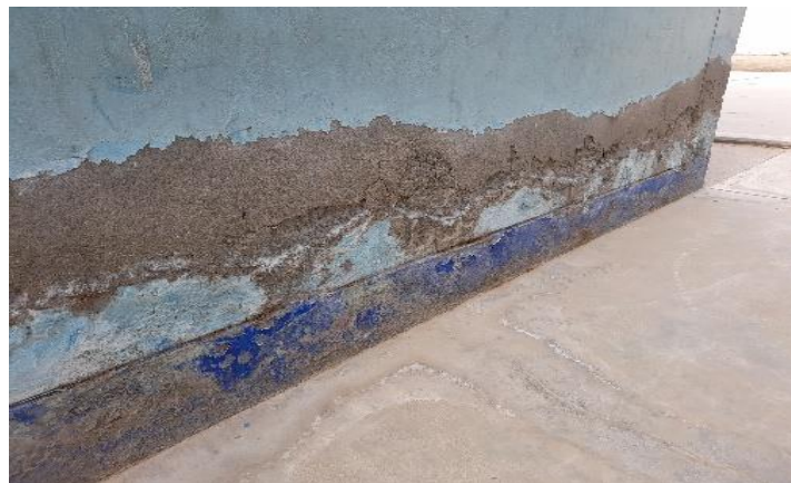
Figura 4. Problema de capilaridad en muro – Pabellón 01
