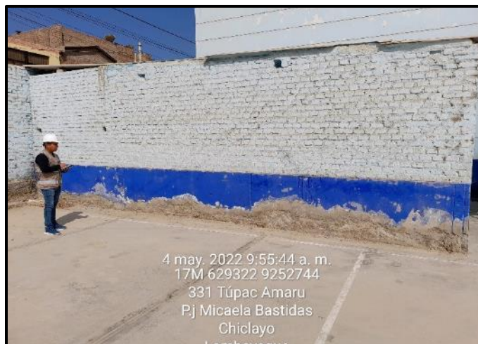
Figura 50. Muro de almacén en mal estado
