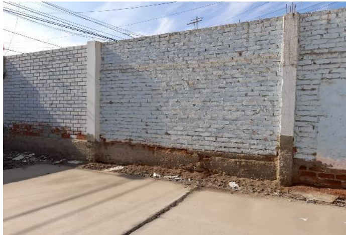
Figura 36. Muros en mal estado – Cerco perimétrico
