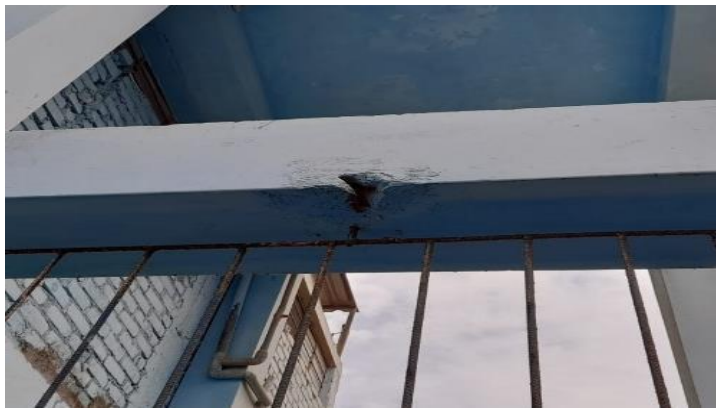
Figura 20. Viga fracturada – Tanque elevado
