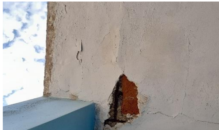
Figura 14. Desprendimiento de losa aligerada – Pabellón 04
