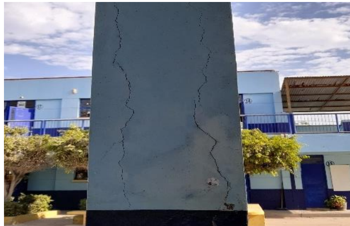
Figura 13. Columna agrietada – Pabellón 04
