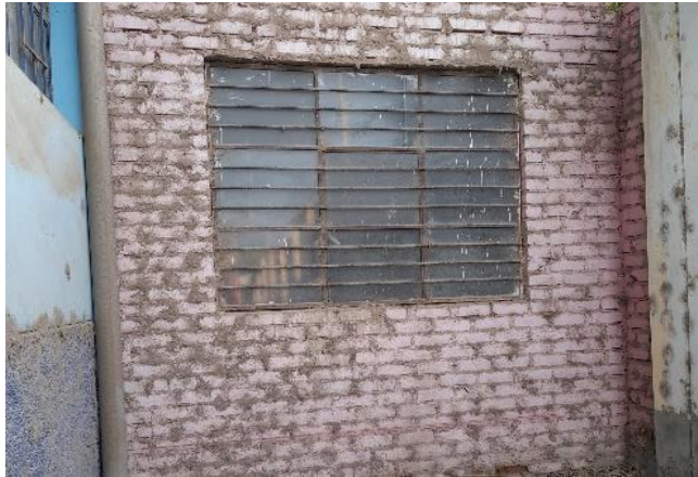
Figura 22. Muro en mal estado - Cocina
