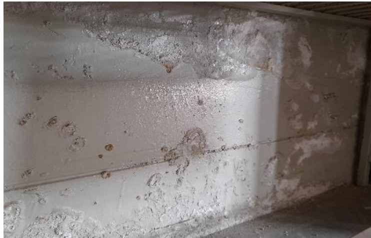
Figura 7. Problemas de salitre en muros – Pabellón 02
