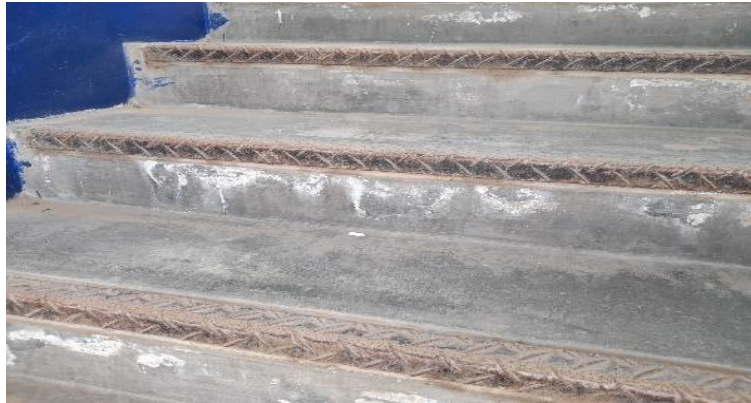
Figura 6. Problemas de salitre en escalera – Pabellón 02
