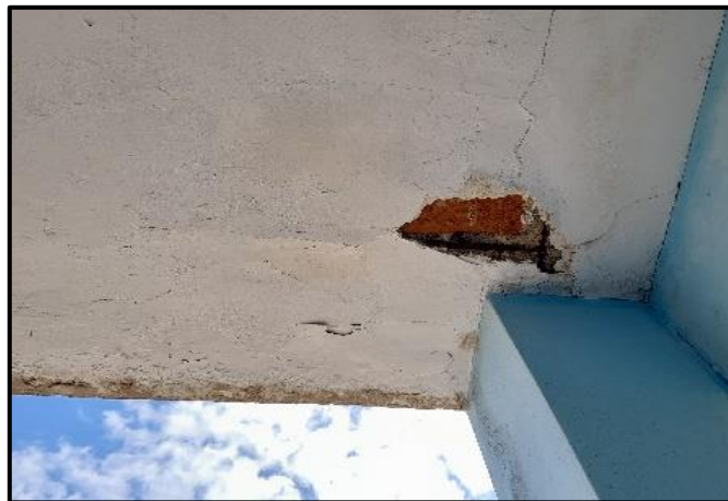
Figura 42. Mal estado de Losa aligerada Pabellón 04
