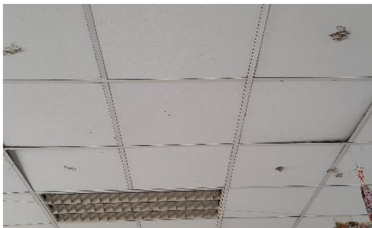
Figura 8. Desprendimiento de falso cielorraso – Pabellón 02
