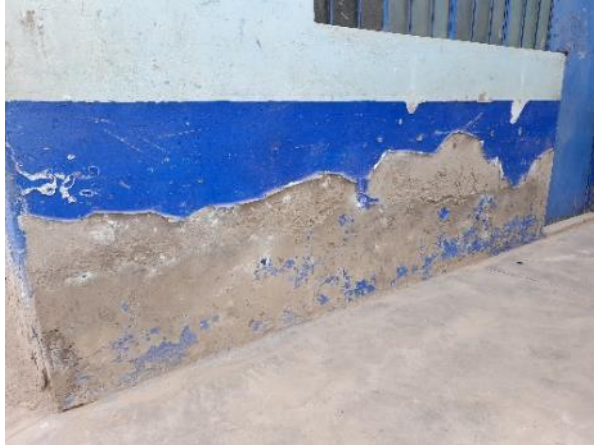
Figura 32. Muro en mal estado - Logística
