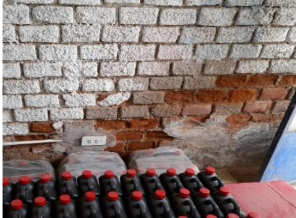
Figura 29. Muro en mal estado - Almacén
