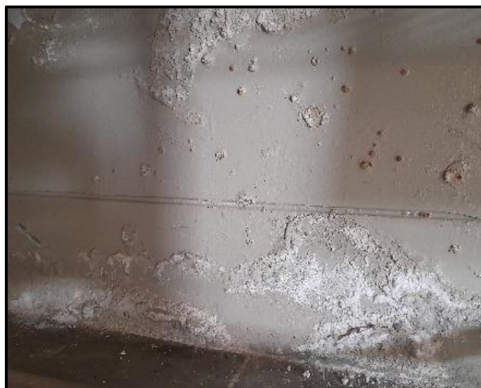
Figura 39. Mal estado de muros en Pabellón 02
