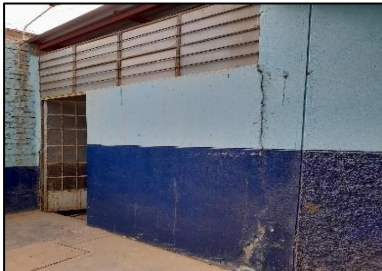
Figura 47. Muro fracturado en Cocina.
