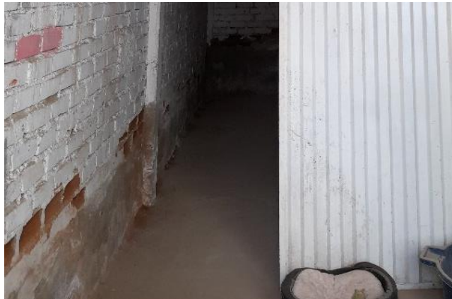
Figura 31. Muro interior en mal estado - Almacén
