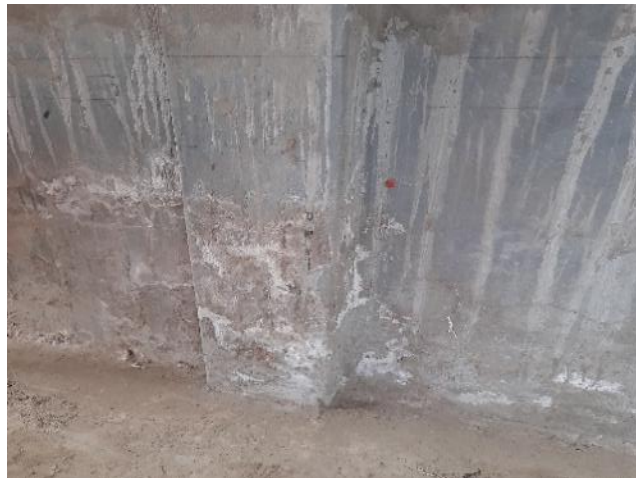
Figura 23. Columna con problema de salitre - Cocina
