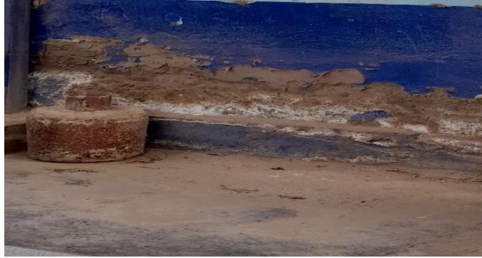
Figura 26. Muro con problemas de salitre - Aula
