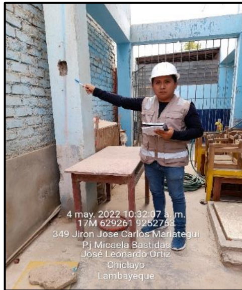
Figura 45. Columnas afectadas de Tanque elevado.
