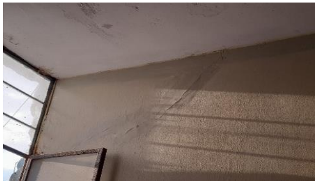
Figura 16. Problemas de humedad – SS.HH.
