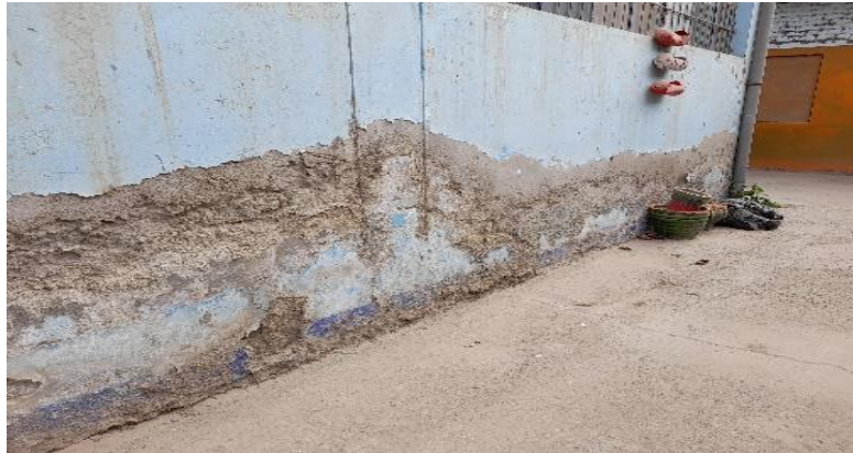
Figura 9. Problemas de capilaridad en muro – Pabellón 03
