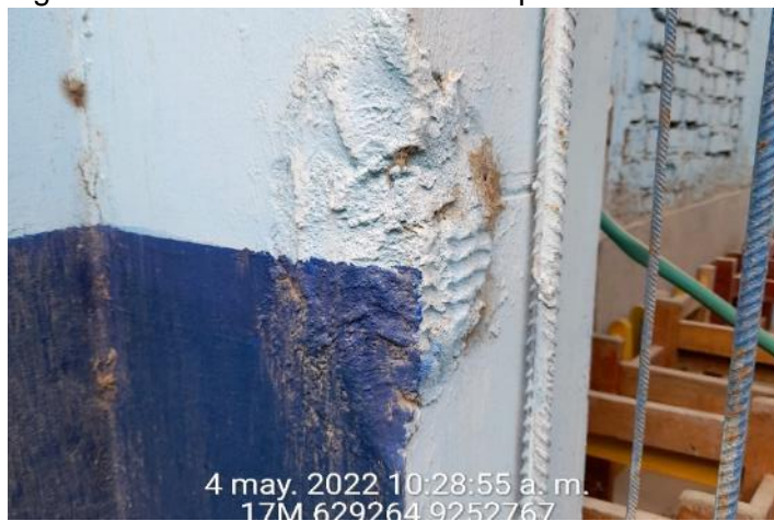
Figura 21. Columna dañada – Tanque elevado
