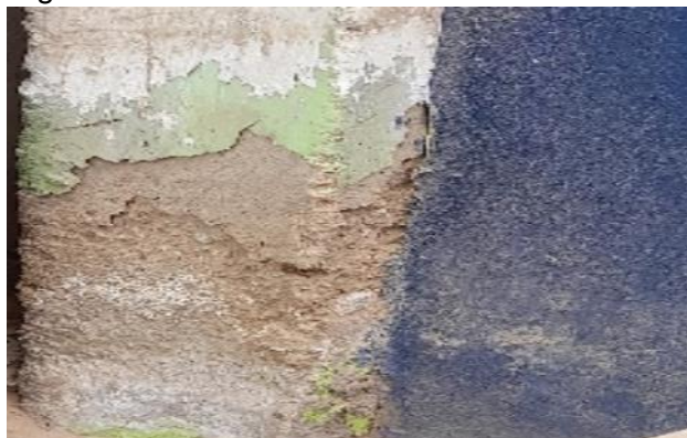
Figura 17. Columna en mal estado – SS.HH.
