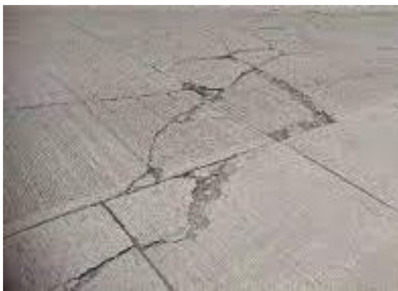
Figura 1. Fisura de esquina en las losas y ligera depresión. Fuente. Internet Google.
