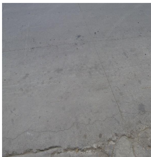
Foto 4. Fisura longitudinal en borde de paño.
