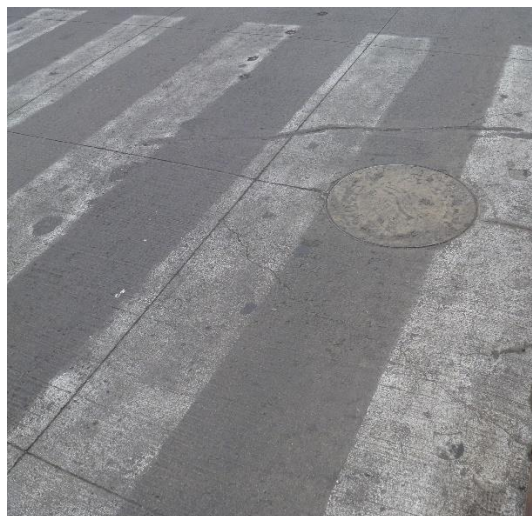
Foto 2. Hundimiento parcial del concreto.
