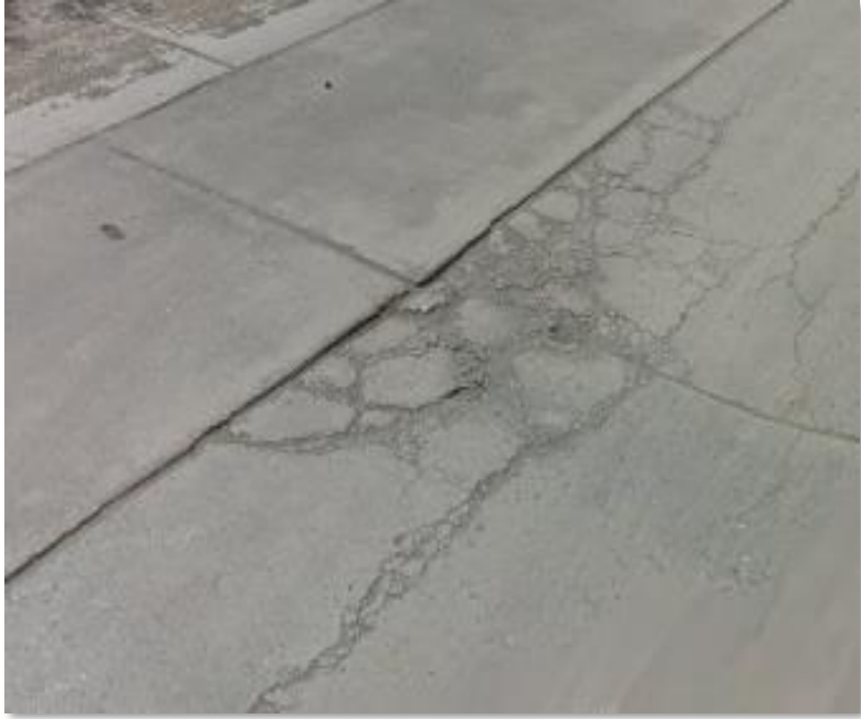
Figura 2. Desgaste y apostillamiento entre las juntas del pavimento. Fuente. Internet Google.
