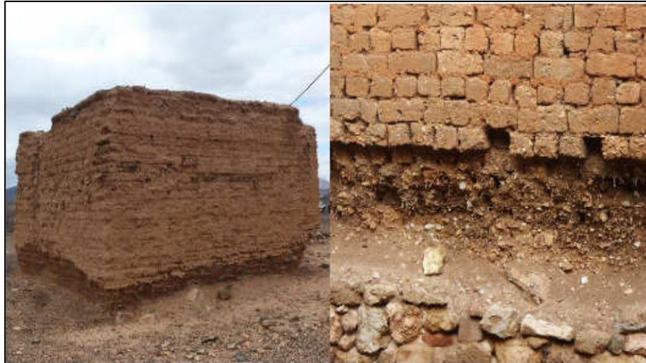
Figura 5. Erosión de la base del muro por acción del agua. Fuente. Resarquitectura, https://bit.ly/3QkjP3n .
