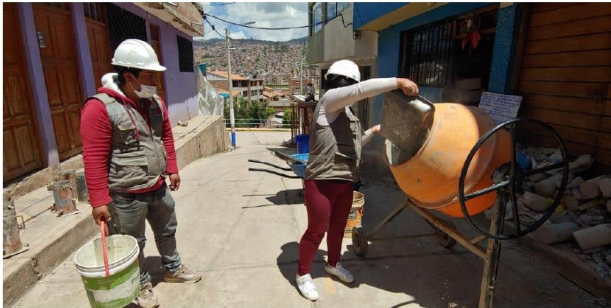
Fotografía 16 y Fotografía 17 Mezcla de los componentes del concreto en el trompo eléctrico.
