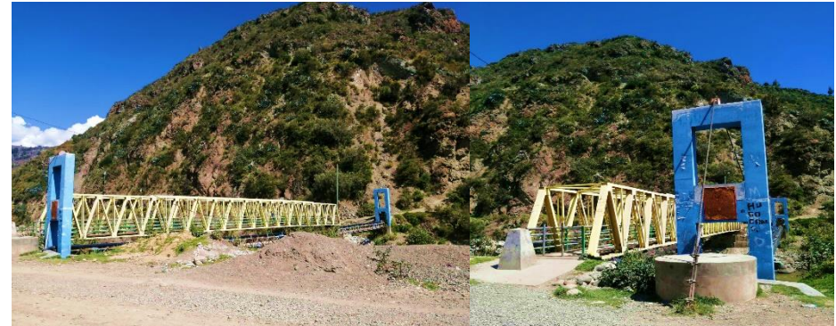
Puente peatonal que conecta al Barrio Taclan con los Barrios Juan Velazco A. y el Barrio Emprendedor 7 de Marzo
