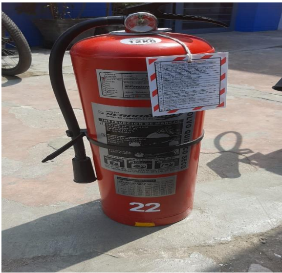
Figura N°9. Señalización de extintores
