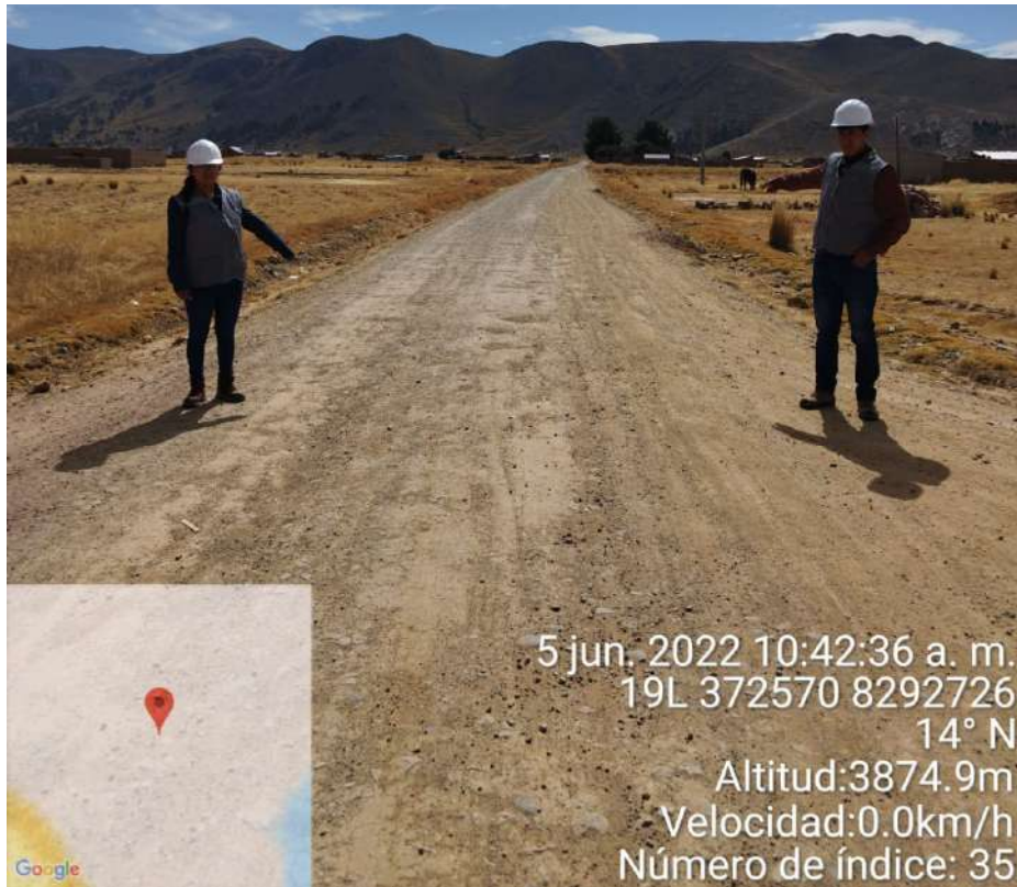
Figura 13. Mal estado de la carretera Unocolla-Chacas. Fuente propia.
