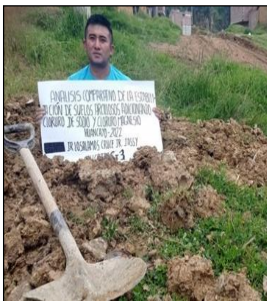
Figura 12: Finalización de la excavación de la calicata y evidencias, según referencia de la norma MTC E 101. FUENTE: Elaboración propia
