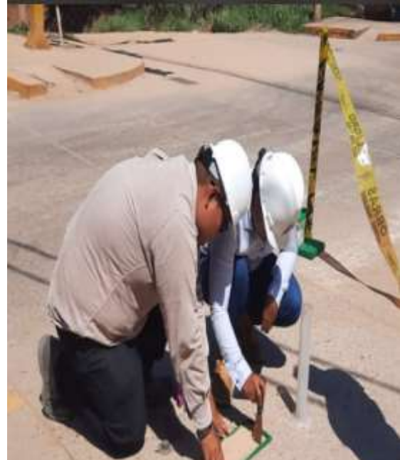
FOTOGRAFIA 10: Se puede observar, la regada homogénea de la arena en el pavimento
