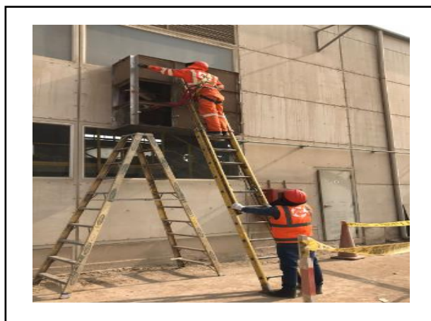
Figura N° 9: Mantenimiento de Ventiladores industriales y mineros.
