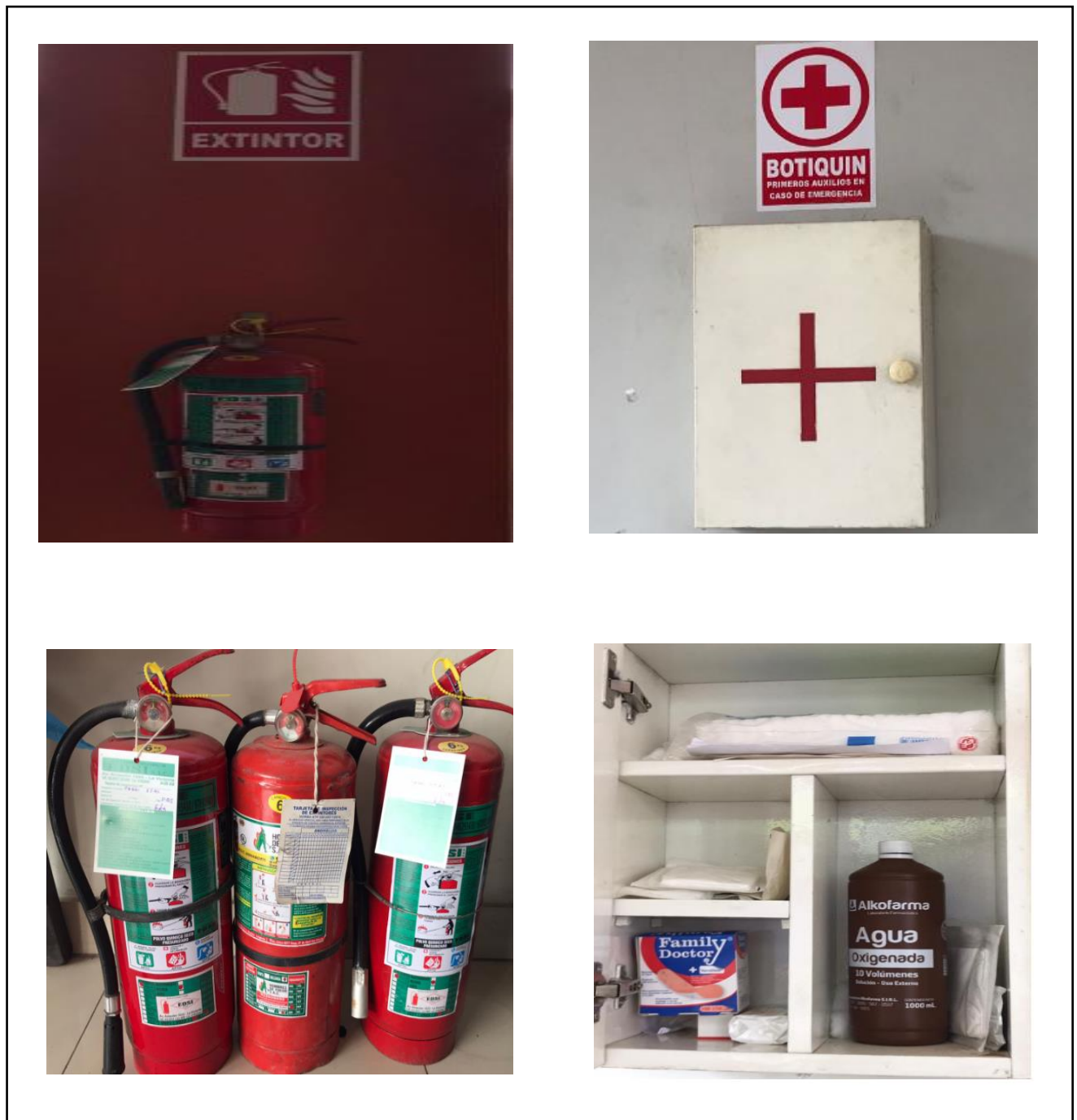
Figura N° 19: Implementación de dispositivos de seguridad.
