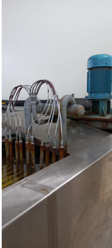
AGITADORES DE LA PLANTA PRODUCTORA DE HIELO
