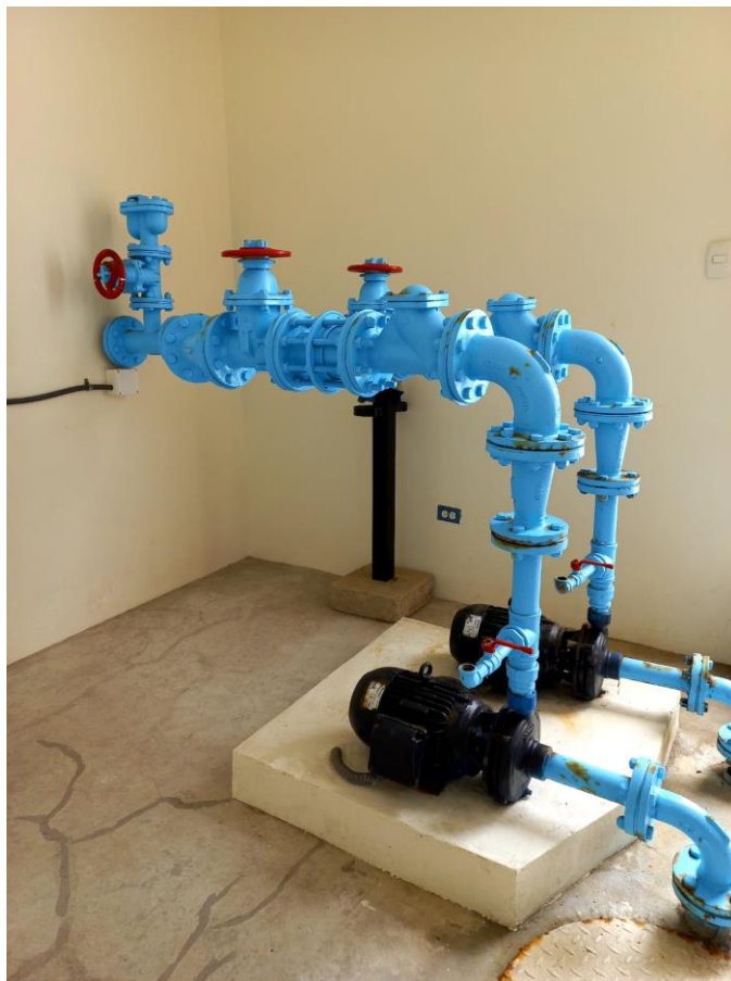
BOMBAS DE AGUA RESIDUALES
