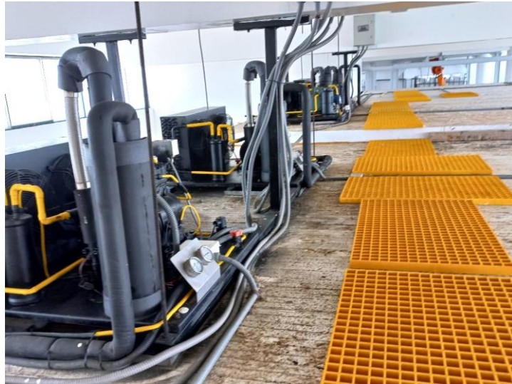
SISTEMA DE REFRIGERACIÓN DE LAS CÁMARAS DE ALMACÉN
