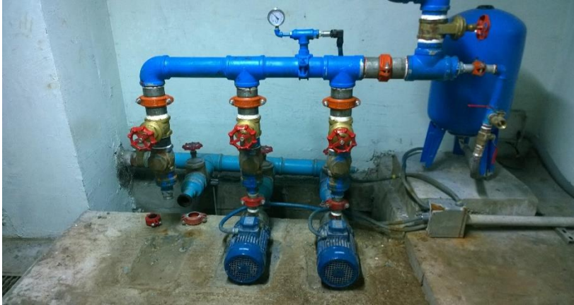
Equipos de presión constante de 220V, 3HP trifásico
