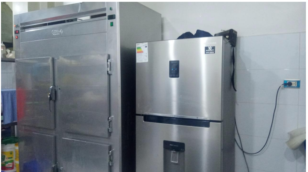
Equipos de refrigeración.
