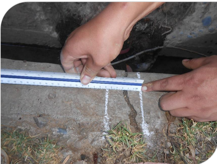
Fotografía N° 09: se observa la medición de la abertura de las grietas y la medición del área afectada.
