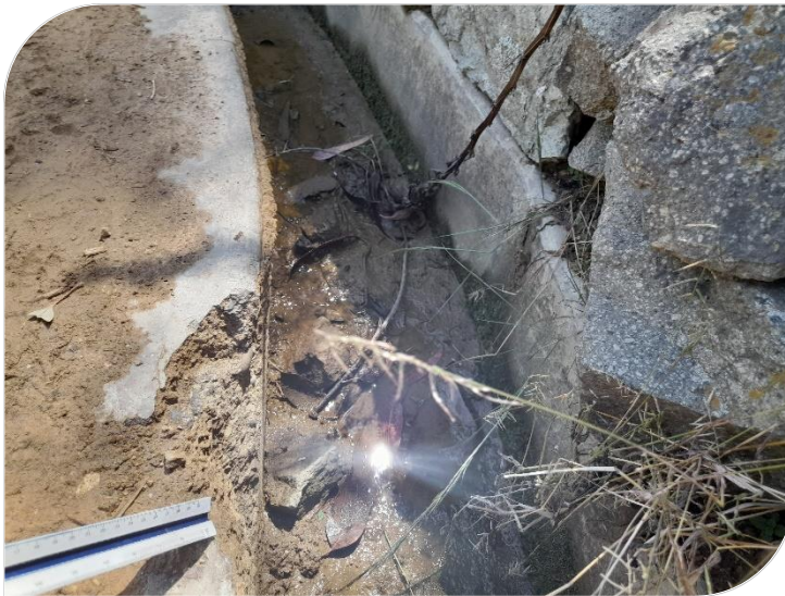
Fotografía Nº 29: En la presente vista fotográfica se observa una rotura de la pared del canal de concreto producto de la caída de piedras del talud adyacente
