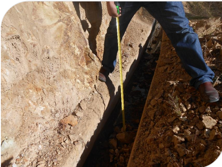
Fotografía N° 18: material proveniente de los taludes obstaculizando el paso del agua
