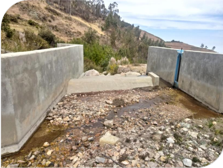
Fotografía N° 30: En la presente vista fotográfica se observa la captación de fondo por medio de rejillas.
