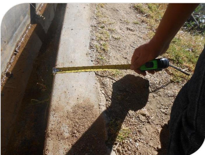
Fotografía N° 03: se observa en la medición del espesor del canal que no es uniforme debido a la falta de encofrado en la parte externa, el espesor medido es de 0.12m
