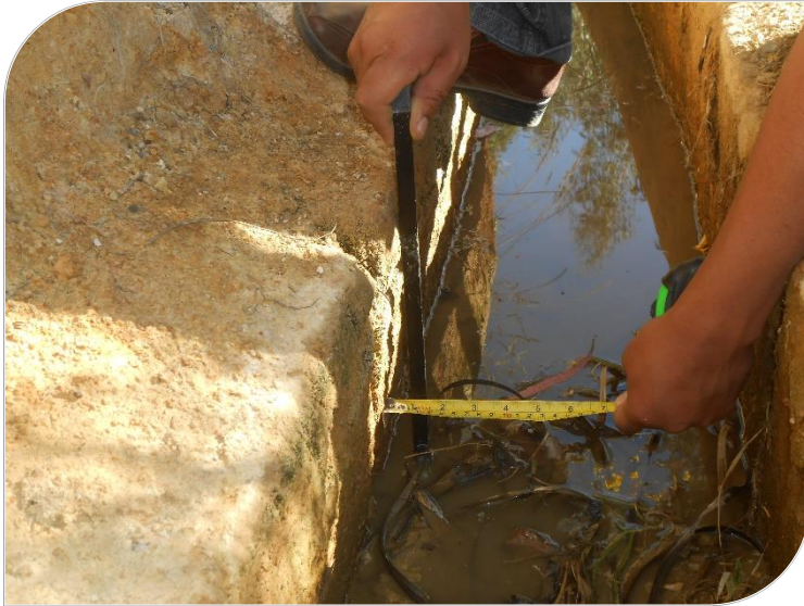
Fotografía N° 25: en la presente vista fotográfica se observa como el talud del margen derecho ha empezado a empujar la estructura generando un ángulo de inclinación con la vertical
