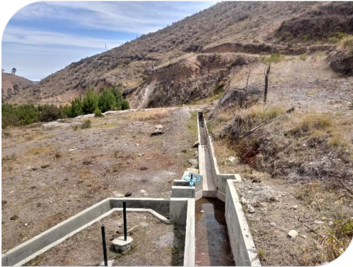
Fotografía N° 30: En la presente vista fotográfica se observa un sistema de regulación mediante una compuerta tipo volante.
