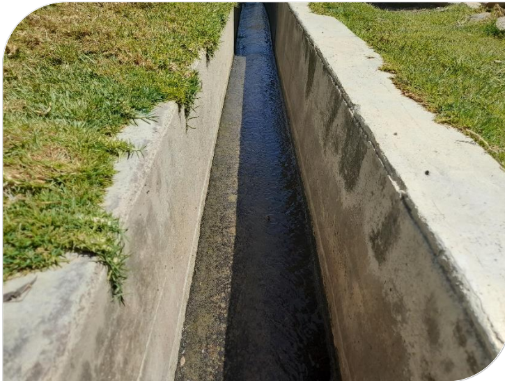
Fotografía N° 23: en la presente vista fotográfica se observa la erosión del piso
