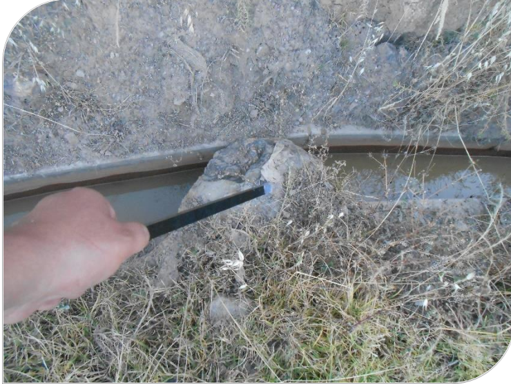
Fotografía Nº 28: En la presente vista fotográfica se observa como una roca obstaculiza y genera impacto en el canal de riego
