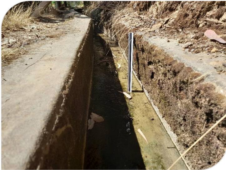
Fotografía N° 26: en la presente vista fotográfica se observa como el talud del margen derecho ha empezado a empujar la estructura generando un ángulo de inclinación con la vertical
