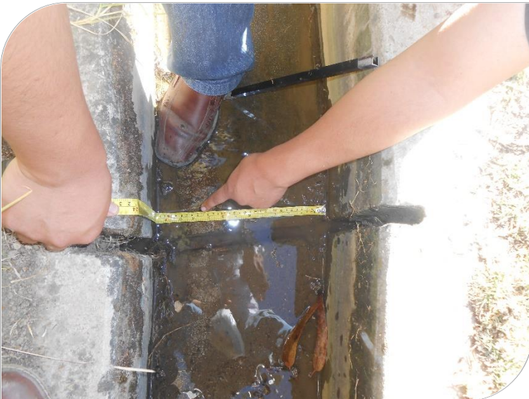
Fotografía N° 15: No solo las pérdidas de asfalto en las juntas sedan en las paredes sino también en los pisos, en la gran mayoría en un 100% de su longitud
