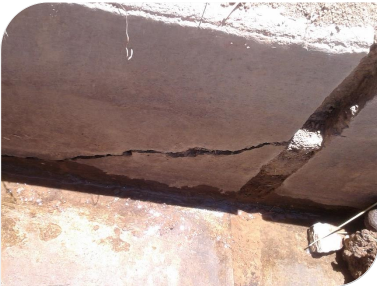
Fotografía N° 08: se observan grietas tanto en las paredes como en el piso del canal.
