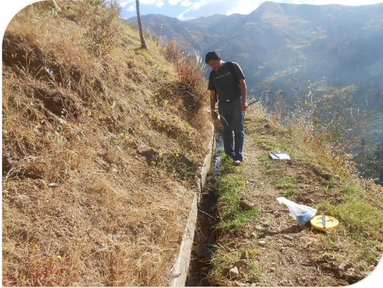
Fotografía N° 16: En la presente vista fotográfica se observa obstrucciones en el canal provenientes de los taludes.
