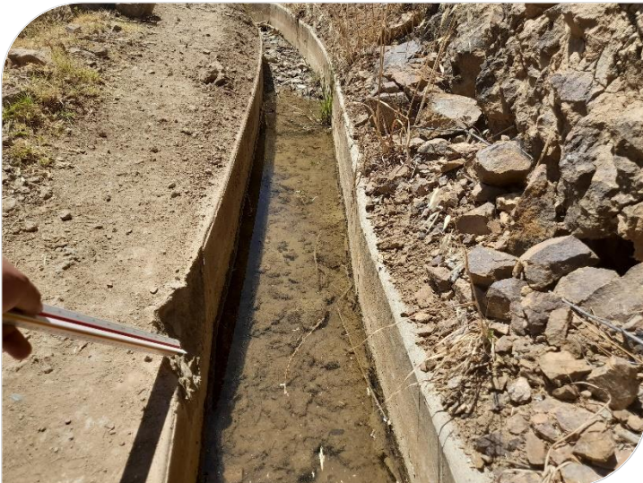
Fotografía Nº 30: En la presente vista fotográfica se observa una rotura de la pared del canal de concreto producto de la caída de
