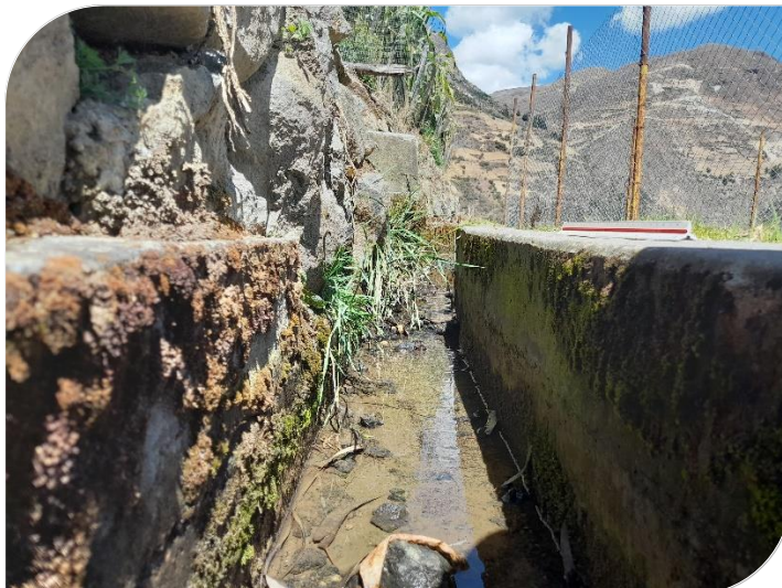
Fotografía N° 24: en la presente vista fotográfica se observa la erosión del piso
