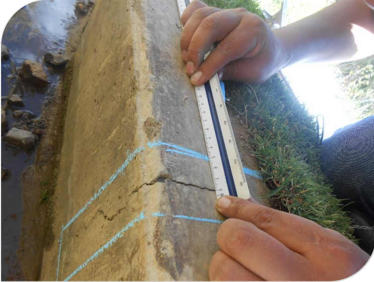
Fotografía N° 07: la presente vista fotográfica muestra la medición de la abertura de la grieta así como del área afectada
