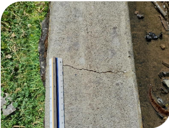
Fotografía N° 05: se observa la medición de la abertura del muro del canal siendo esta igual a 1mm, que nos indica que es una fisura.
