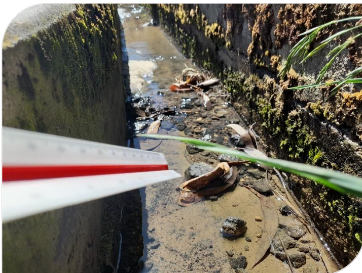
Fotografía N° 11: se observa la patología de hundimiento en la losa de fondo del canal.
