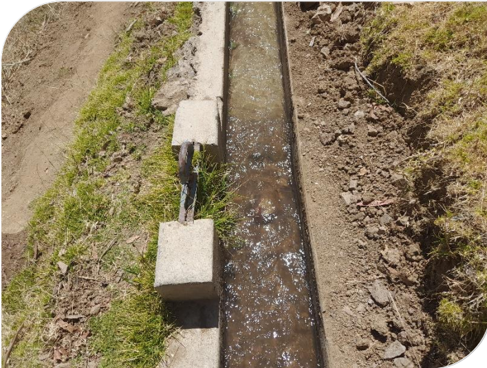
Fotografía N° 32: En la presente vista fotográfica se observa tomas laterales las cuales se encuentran en mal estado.
