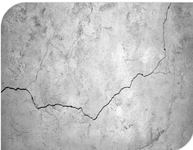
Fotografía N° 06: se observa fisuras tipo tela de araña en las paredes del canal
