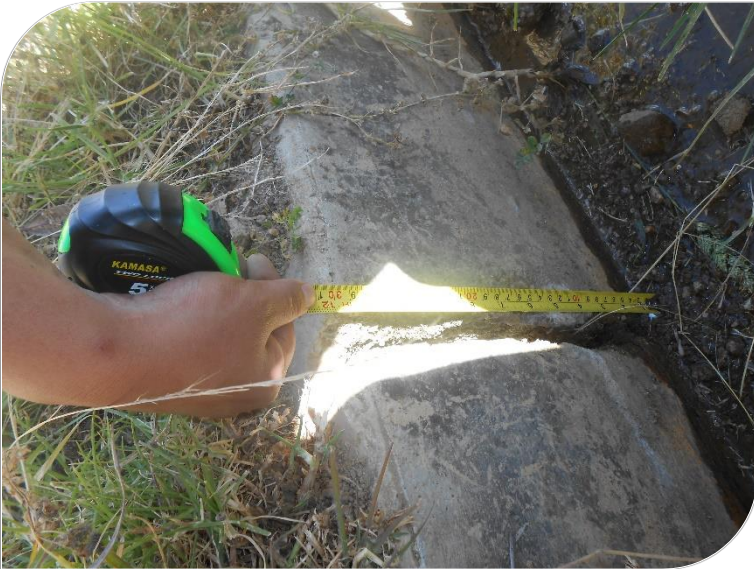
Fotografía N° 14: Se observa la pérdida total del material de las juntas en las paredes del canal
