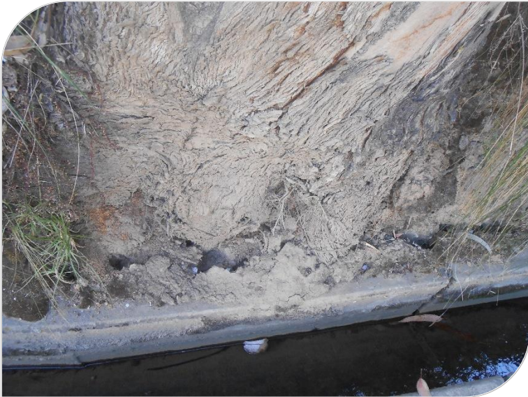
Fotografía N° 20: Se observa el daño que provoca las raíces de los árboles en el muro del canal, generando grietas y probablemente más adelante el colapso de la pared en esta zona
