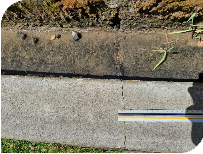
Fotografía N° 04: se observa la medición de la abertura del muro del canal siendo esta igual a 1mm, que nos indica que es una fisura.
