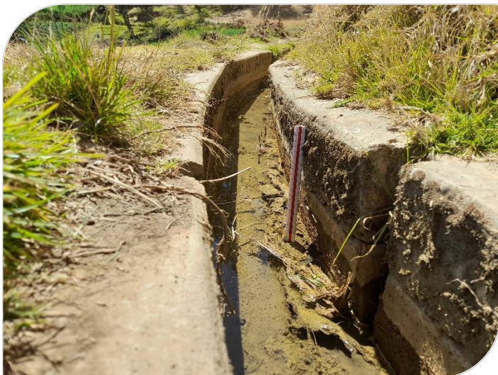
Fotografía N° 27: en la presente vista fotográfica se observa como el talud del margen derecho ha empezado a empujar la estructura generando un ángulo de inclinación con la vertical
