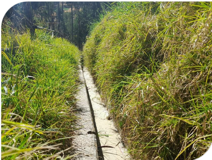
Fotografía N° 21: Se observa como la vegetación ha empezado a ocupar áreas de la estructura del canal
