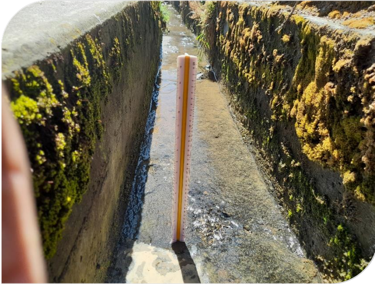
Fotografía N° 10: se observa la patología de hundimiento en la losa de fondo del canal.
