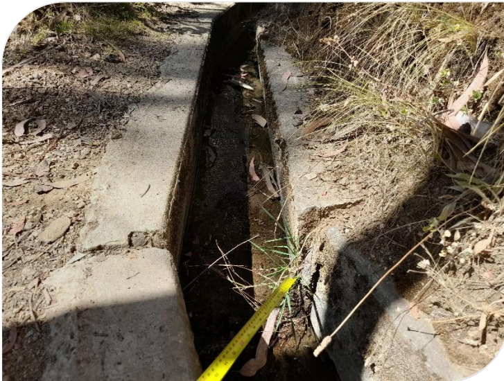
Fotografía N° 11: se observa la patología de hundimiento en la losa de fondo del canal, producto de ello se observa el desnivel entre los muros en la junta de construcción
