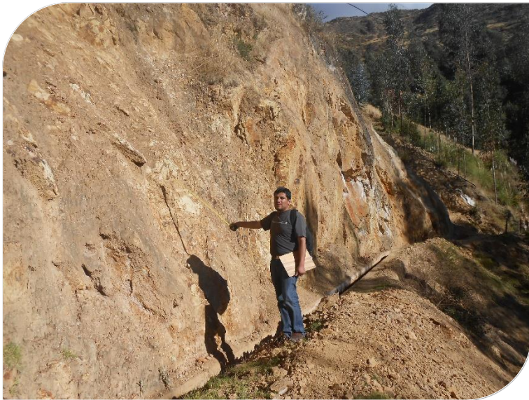
Fotografía N° 17: zona de falla geológica casi en más de 25 ml el canal se encuentra obstruida parcial y total mente.
