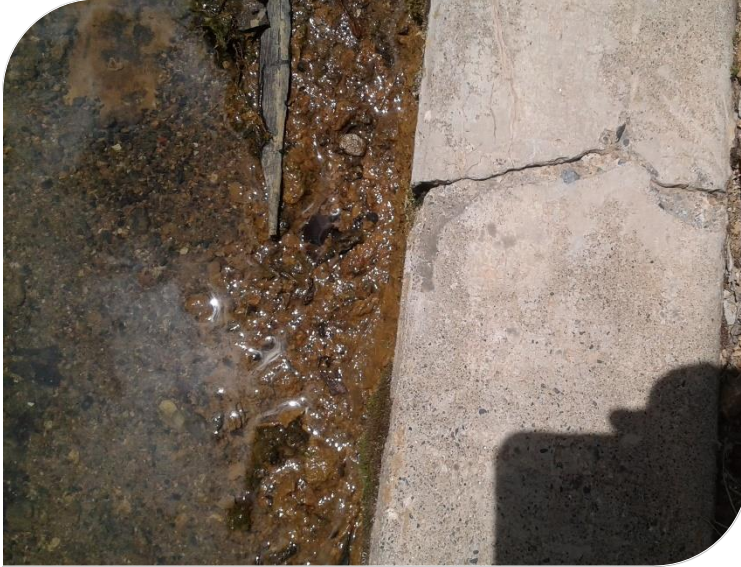
Fotografía N° 22: en la presente vista fotográfica se observa la erosión del piso
