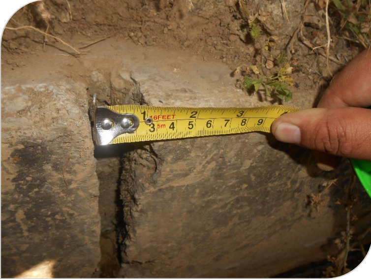
Fotografía N° 13: En la presente vista fotográfica se observan las mediciones de la abertura de las juntas de dilatación, y además se observa la pérdida del asfalto en un 100 % de su longitud.
