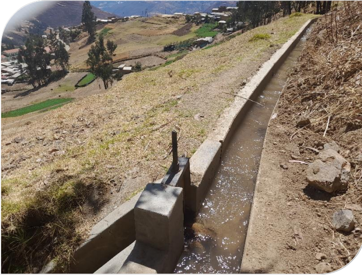
Fotografía N° 31: En la presente vista fotográfica se observa tomas laterales las cuales se encuentran en mal estado.
