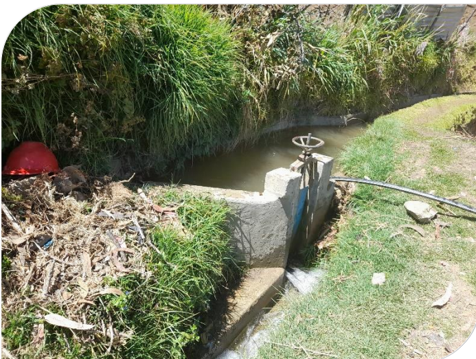
Fotografía N° 33: En la presente vista fotográfica se observa un desarenador, el cual se encuentra en mal estado.
