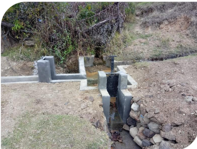
Fotografía N° 30: En la presente vista fotográfica se observa un partidor de agua
