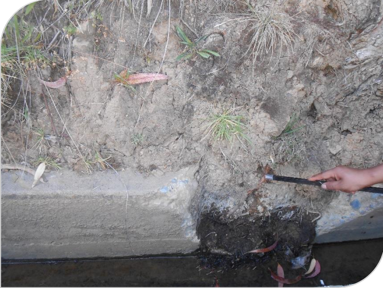
Fotografía N° 19: En la presente vista fotográfica se observa la pérdida total de la pared de canal por el empuje que provoca la raíz de los arboles
