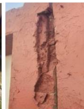
4. DETERIORO EN LAS COLUMNAS
