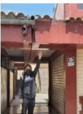
9. VIGAS EN DETERIORO
