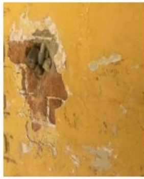
5. HOYOS EN LAS PAREDES
