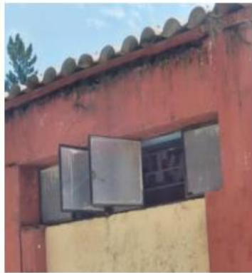
6. TECHOS EN MALAS CONDICIONES
