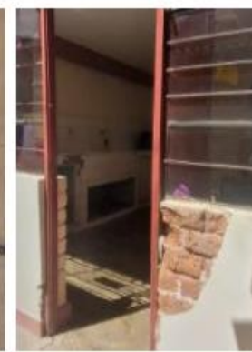
8. DETERIORO EN LAS PAREDES
