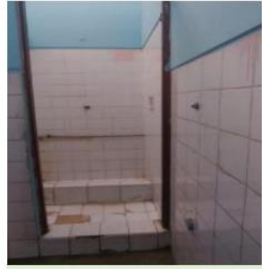
2. DUCHAS DETERIORADAS Y SIN PUERTAS
