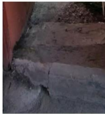
6. DETERIOROS EN LAS CIRCULACIONES
