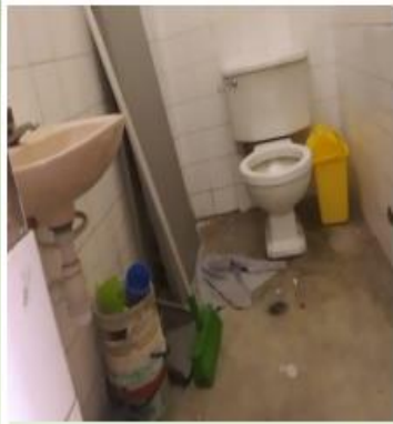
1. SS.HH EN MALAS CONDICIONES
