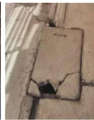
7. DETERIORO EN LOS PROTECTORES DEL DESAGUE
