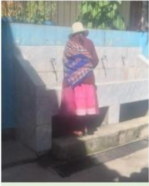
3. LAVADEROS EN MALA CONDICIÓN
