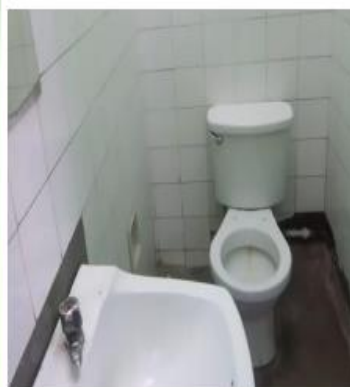
5. DETERIORO EN LOS SS.HH
