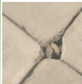
1. HUECO EN EL PATIO PRINCIPAL
