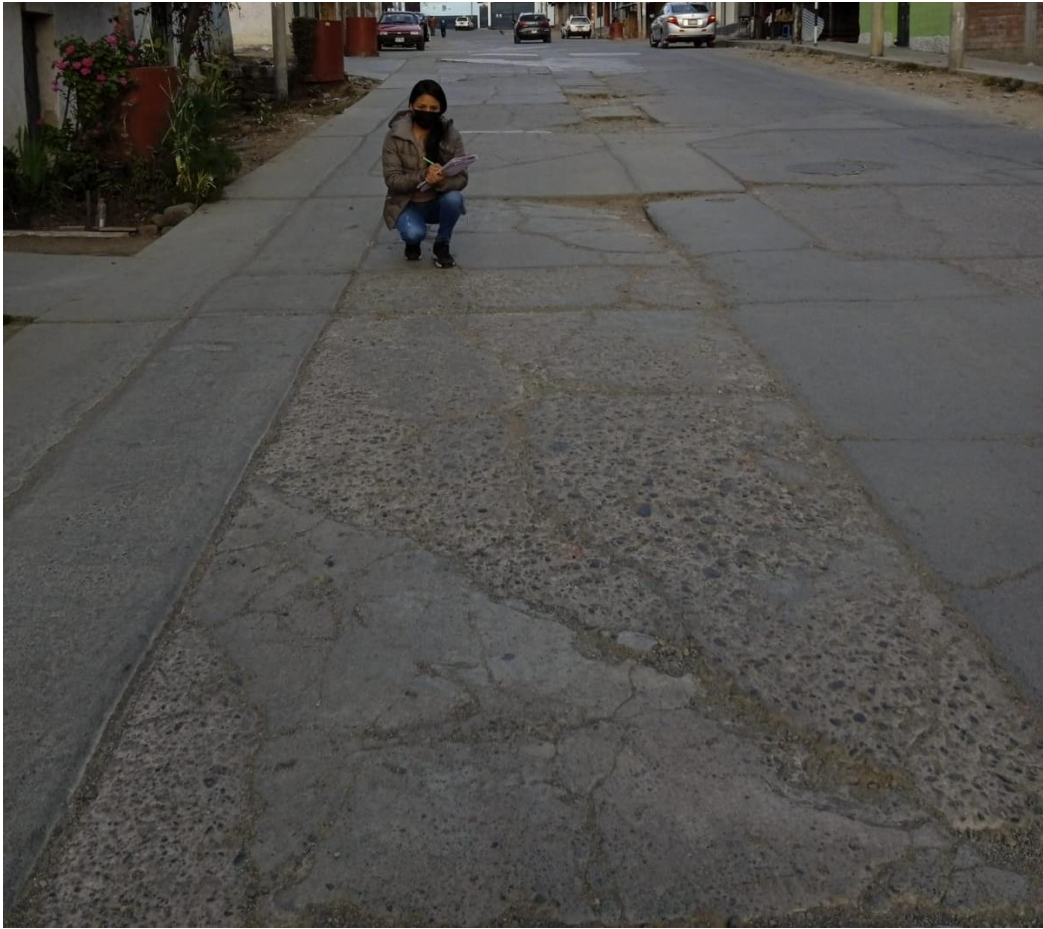
Anexo 8. Estado actual de la avenida Diego Ferrer – Grieta Lineal
