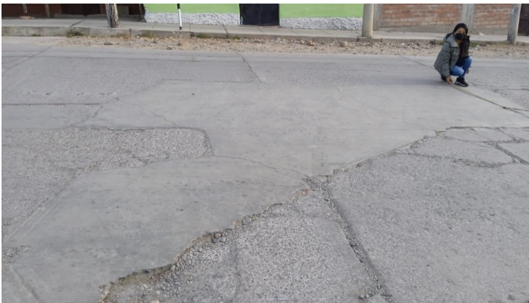
Anexo 9. Estado actual de la avenida Diego Ferrer – Parcheo Grande
