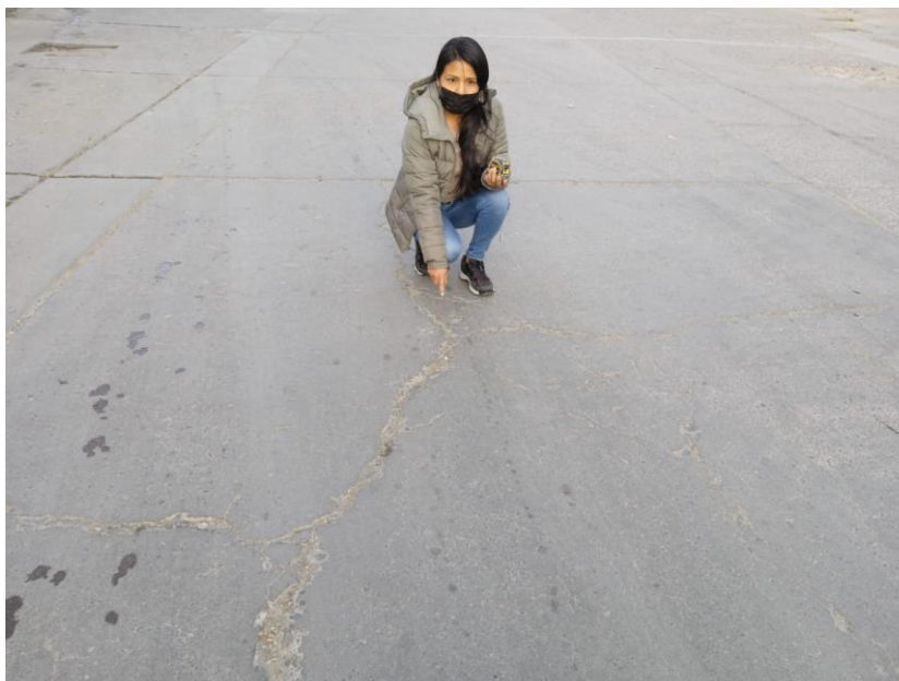
Anexo 5. Estado actual de la avenida Diego Ferrer – Losa Dividida
