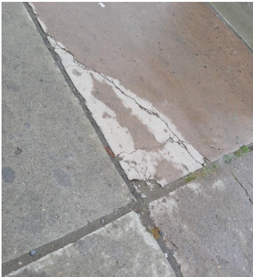
Anexo 4. Estado actual de la avenida Diego Ferrer – Grieta de Esquina
