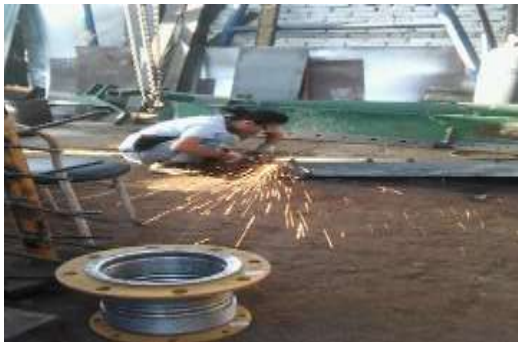
Figura 39: Área de esmerilado , Personal esmerilando pieza metálica en posición incorrecta y sin EPP adecuado
