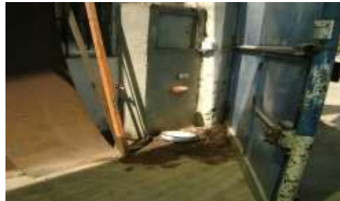
Figura 06: Caja de registro eléctrico presenta humedad en el piso.
