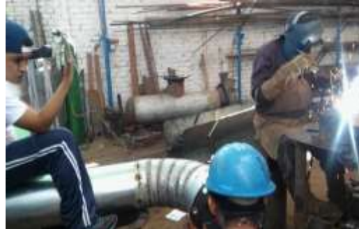
Figura 37: Área de soldadura , Personal expuesto a la proyección de luz que emite el proceso de soldadura sin equipos de protección.
